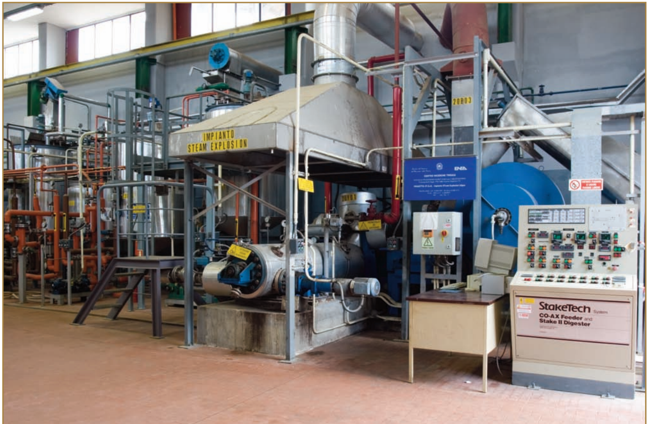
Apparati di alimentazione della biomassa (a destra) e reattore tubolare di Steam Explosion (al centro dell'immagine)
