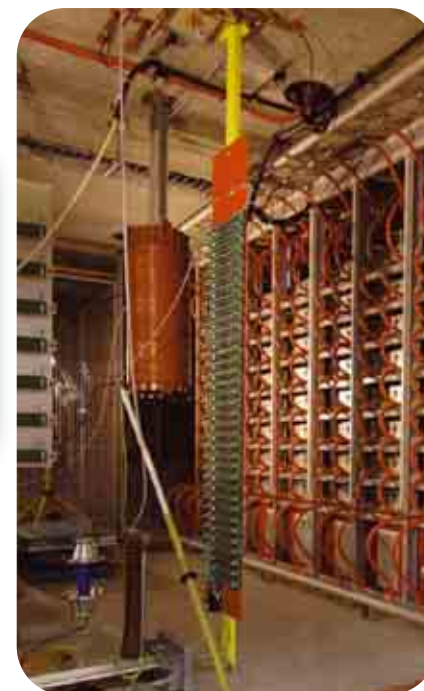
Alimentatore elettrico ad alta tensione per l'impianto di prova europeo del sistema di riscaldamento ECRH di ITER - High voltage power supply for the European test facility of the ECRH heating system for ITER (OCEM)
