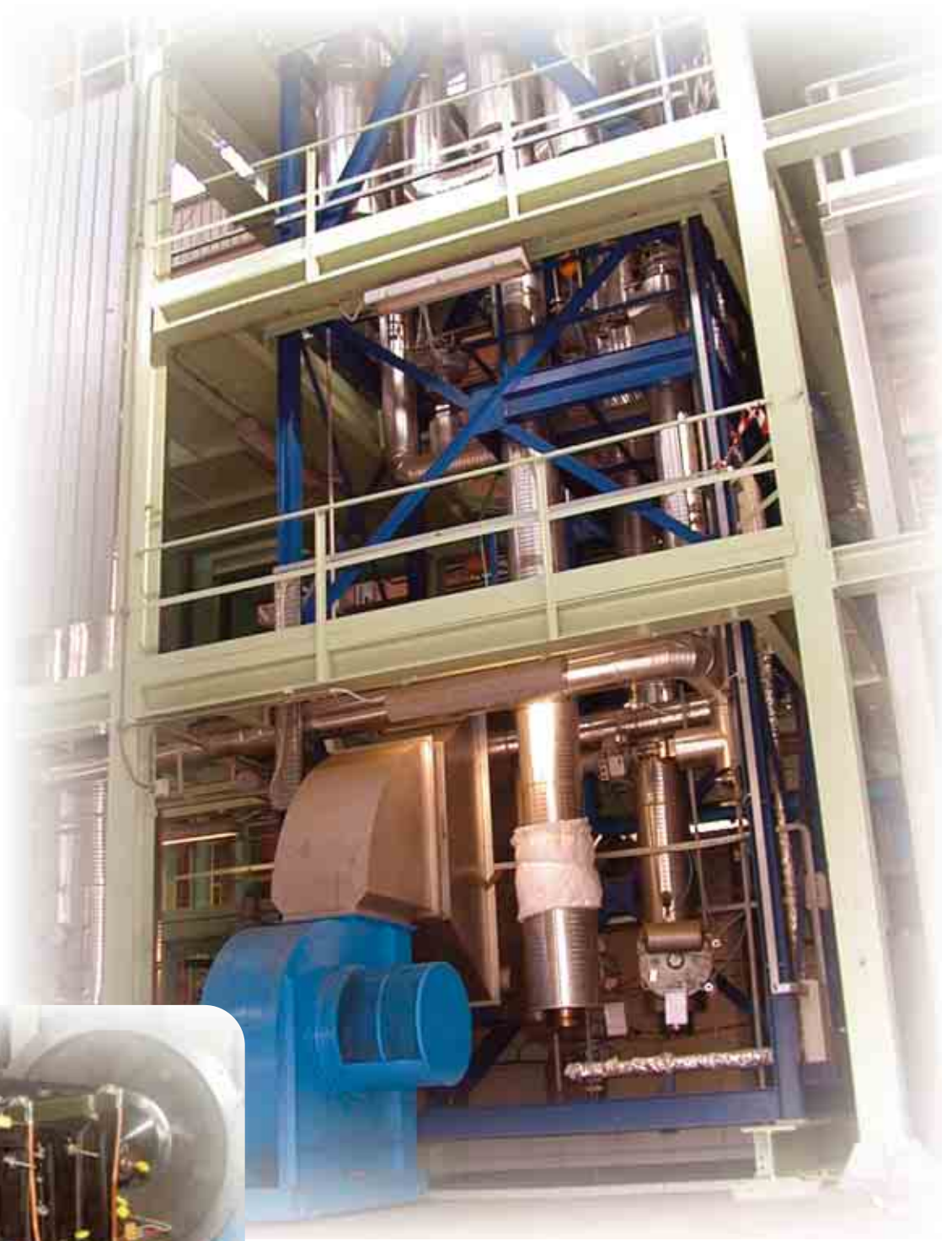
Impianto ad elio HE-FUS 3. Helium loop facility HE-FUS 3.
