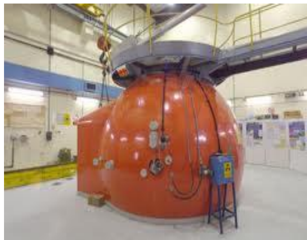
Figura 1 - TAPIRO sala reattore.
