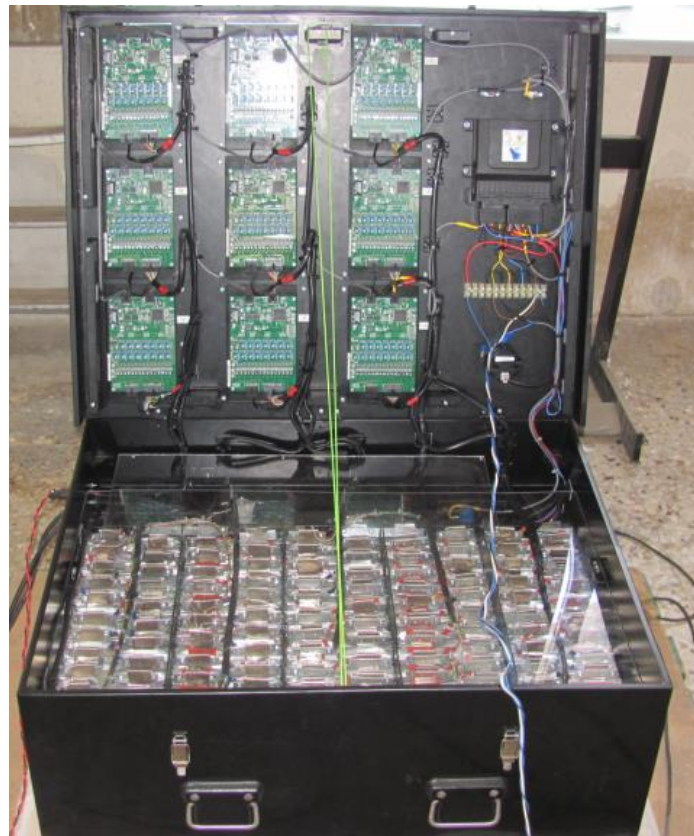
Figura 22. La batteria litio-ferro-fosfato
