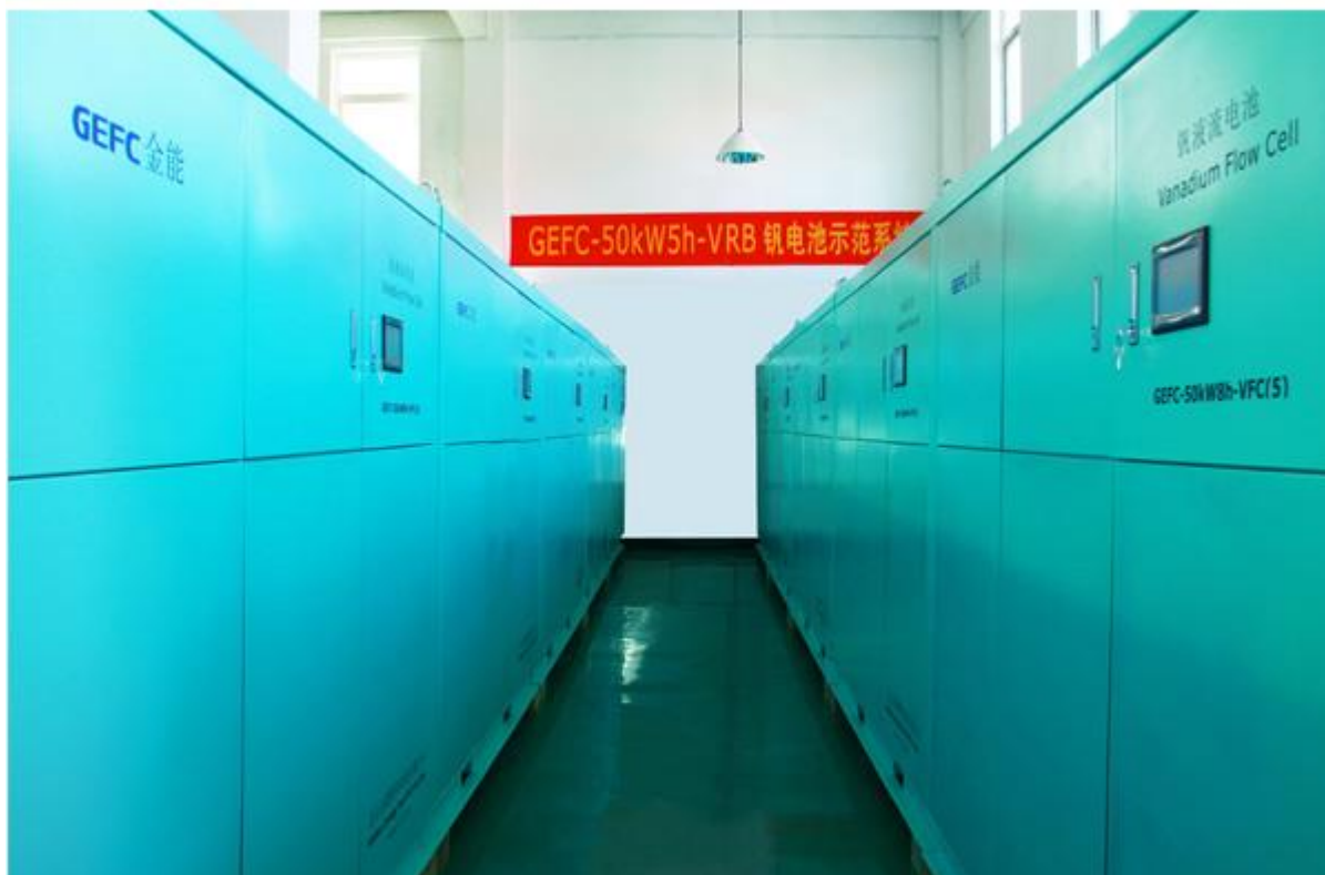
Figura 8. Sistema GEFC da 50 kW/250 kWh
