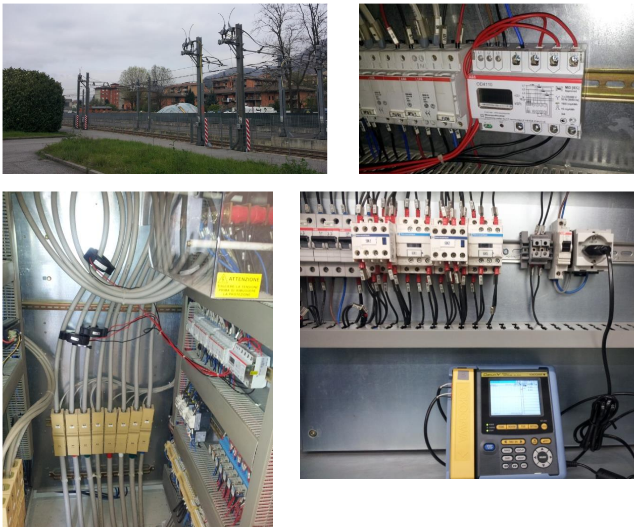
Figura 12: Strumenti installati. In alto a sinistra, porzione di linea; in alto a destra, contatore energia servizi ausiliari BT; in basso a sinistra, quadro servizi ausiliari BT; in basso a destra, data logger all'interno del quadro DC
