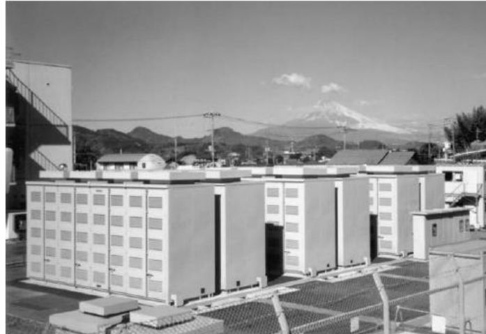
Figura 2. Sistema di accumulo Sodio/Zolfo NGK operativo a Ohito, Giappone, in a load-leveling mode (6MW/48 MWh). Questa batteria è una delle due più grandi batterie sodio/zolfo mai costruite ed è operativa dagli inizi del 1998 (Fonte: Courtesy of Tokyo Electric Power Ltd.)
