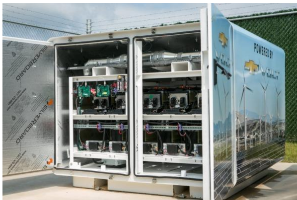
Figura 19. Sistema di accumulo realizzato con batterie Chevrolet
