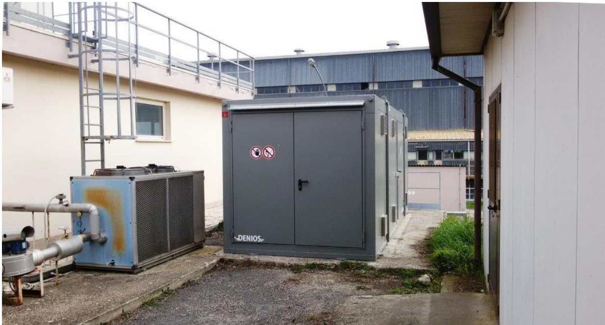
Figura 4. . Box stoccaggio sicurezza batterie: ingressi lato corto e lungo
