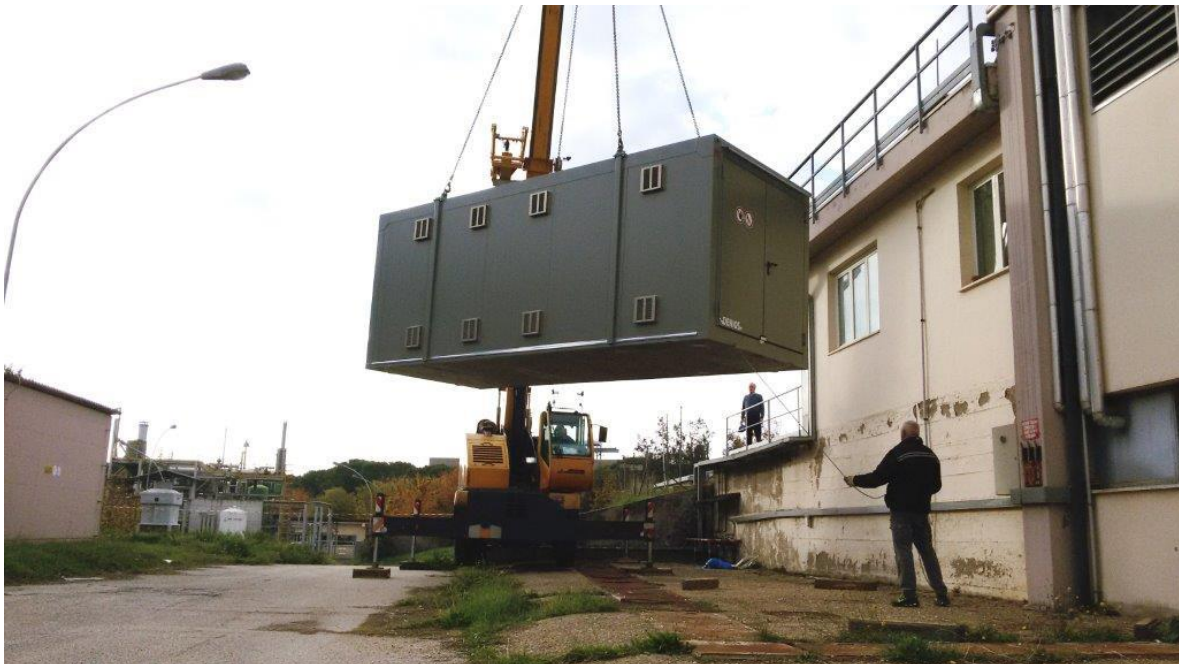
Figura 3. Box stoccaggio sicurezza batterie: griglie di ventilazione
