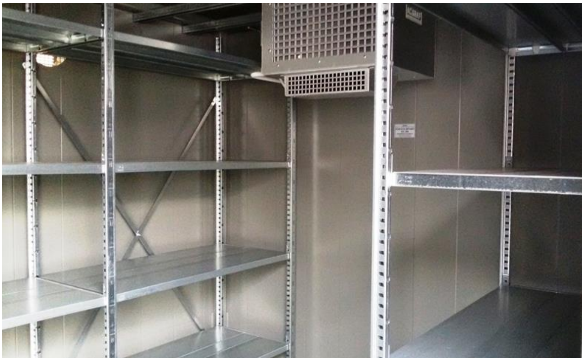
Figura 5. Box stoccaggio sicurezza batterie: interno lato lungo (storage celle e batterie movimentabili a mano)
