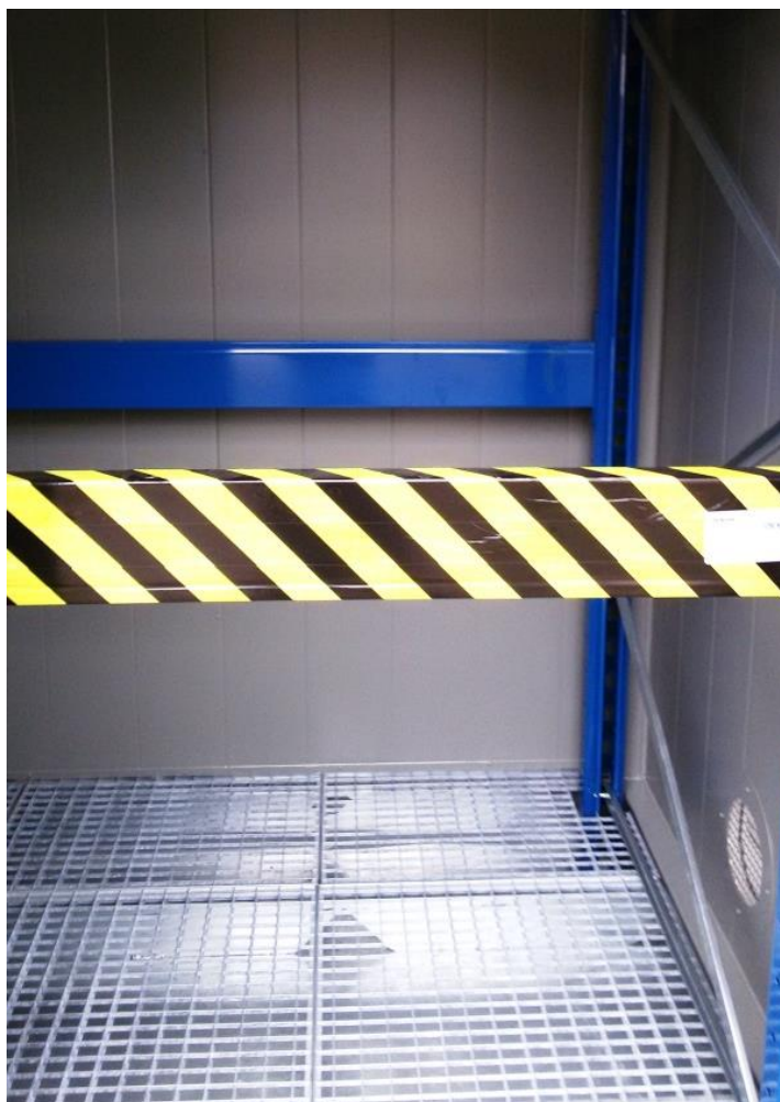
Figura 6. Box stoccaggio sicurezza batterie: particolare lato corto (posizionamento batterie grandi con transpallet)
