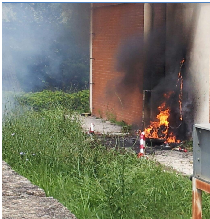
Figura 25. Rogo a seguito di test di overvoltage.
