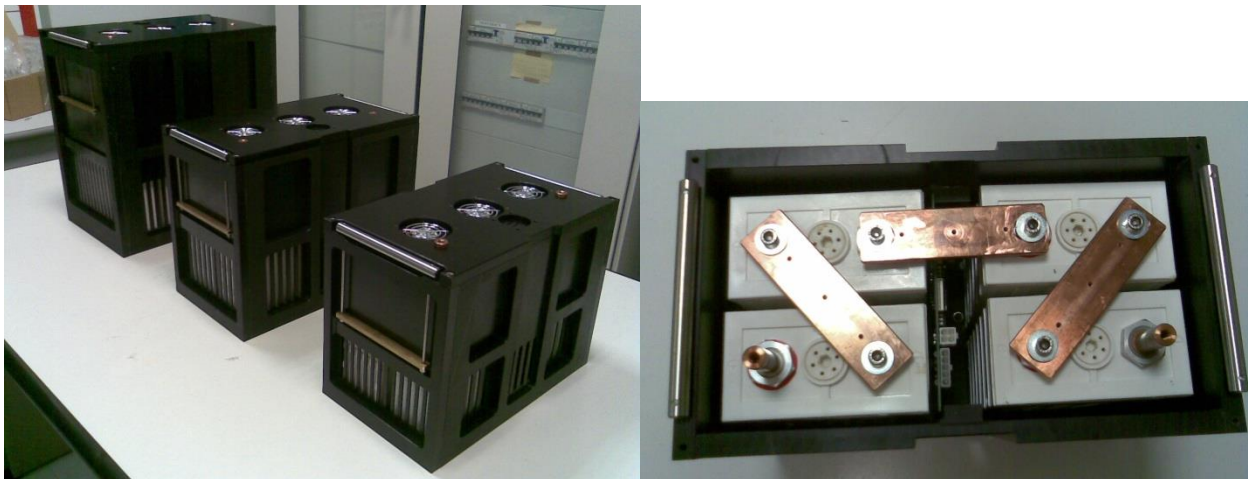
Figura 8. Moduli di celle prodotti da Enea a) vista d'insieme b) Spazi interni e connessioni di potenza
