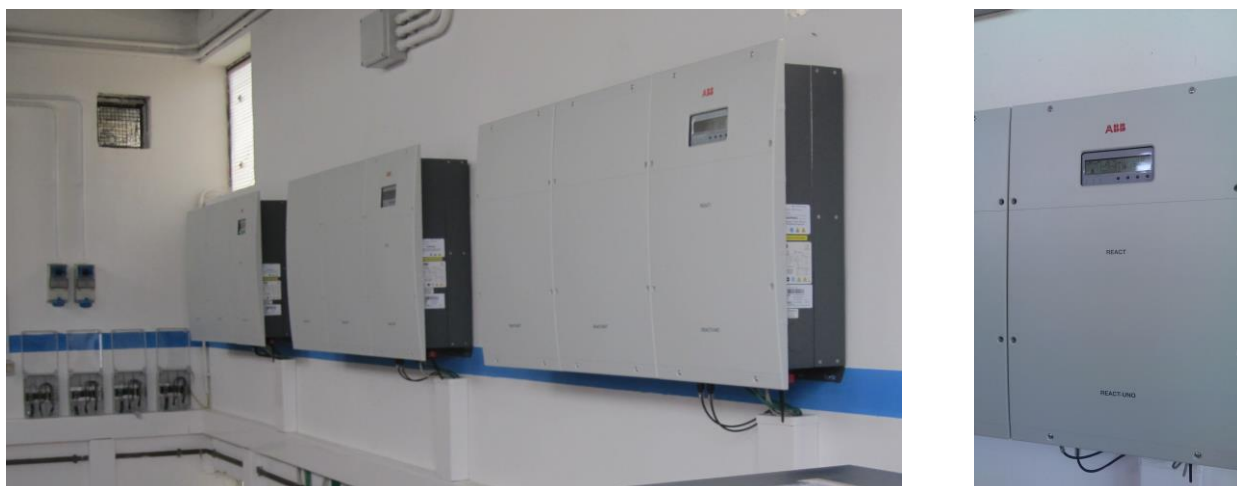
Figura 7. I tre inverter fotovoltaici ABB-REACT-UNO 4.6 TL (a dx l'unità riferita alla fase 2).
