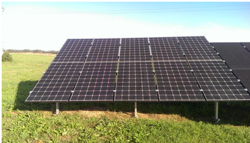
Figura 1. Il campo fotovoltaico (3,25 kW) dell'impianto monofase.
