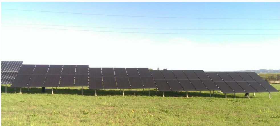
Figura 6. Il campo fotovoltaico (12 kW) dell'impianto trifase.
