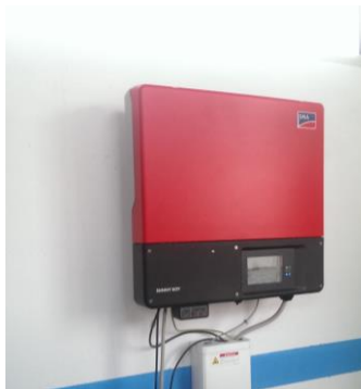
Figura 4. L'inverter fotovoltaico (3 kW) dell'impianto monofase.
