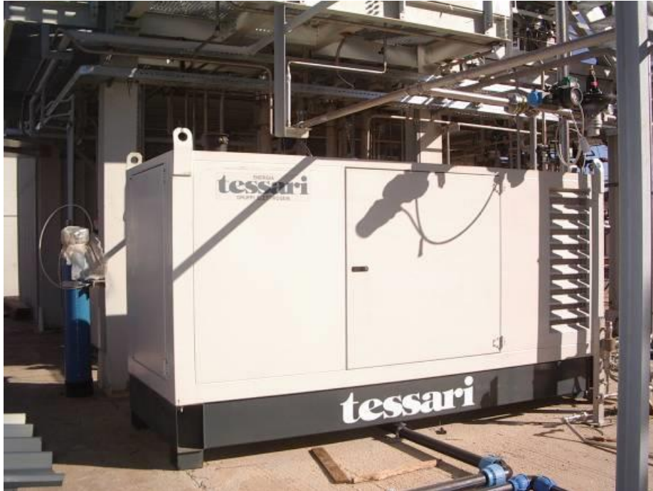
Figura 43. Gruppo elettrogeno Tessari da 24 kW elettrici
