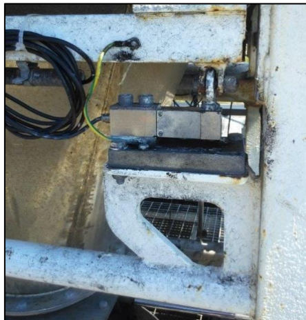
Figura 13. Posizionamento della cella di carico nella tramoggia superiore del sistema di carico
