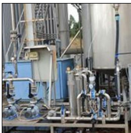
Figura 35. Vasca di accumulo e sistema di ricircolo acqua di lavaggio
