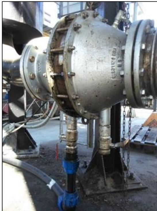
Figura 37. Bocchelli di spurgo della valvola rompifiamma
