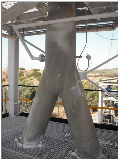
Figura 14. Tubazioni del sistema a Y per il caricamento del combustibile nel gassificatore
