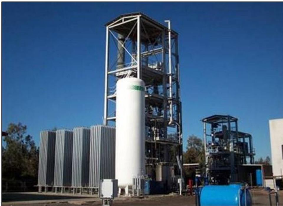
Figura 1. La piattaforma pilota Sotacarbo
