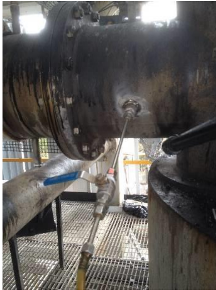
Figura 23. Punto di campionamento gas in corrispondenza del condotto uscente dalla sommità del gassificatore
