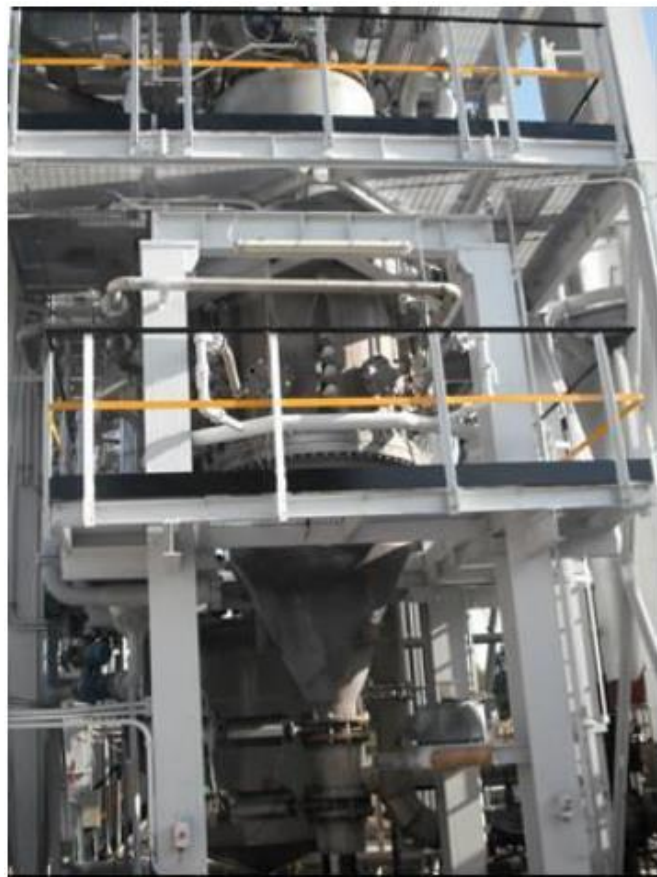
Figura 2. Gassificatore impianto dimostrativo
