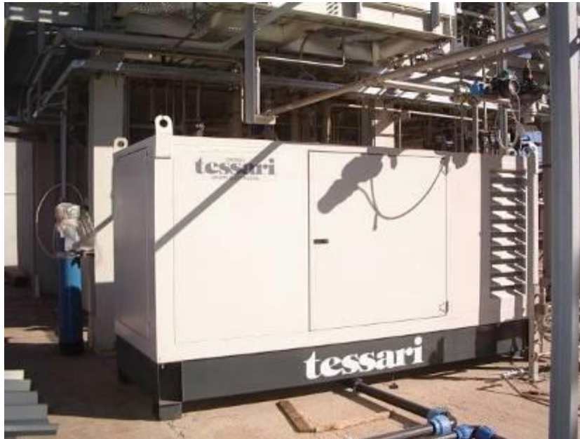
Figura 8. Gruppo elettrogeno da 24 kW elettrici.
