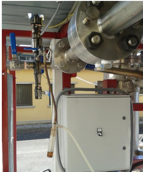
Figura 13. Particolare del prelievo del gas con predisposizione per la raccolta del tar
