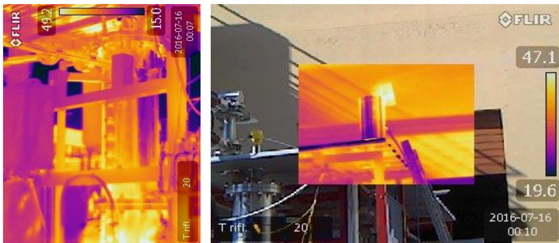
Figura 14. Immagine termografica con dettaglio di gassificatore e torcia
