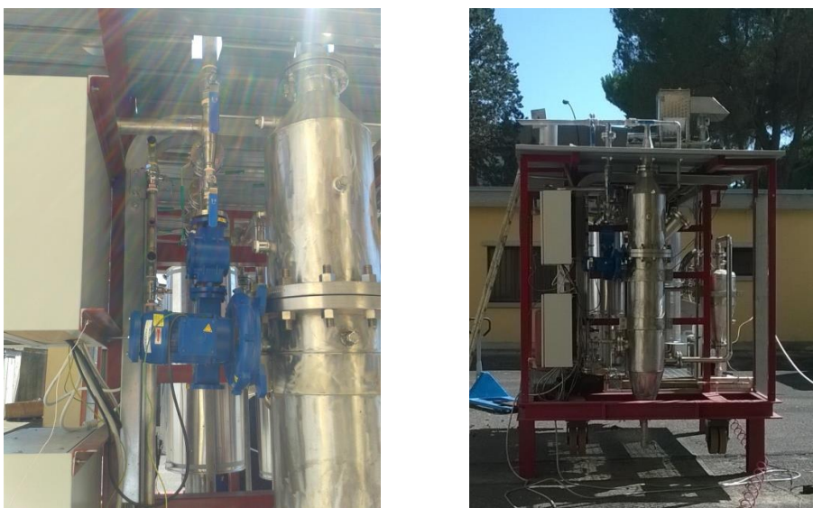
Figura 11. Soffiante utilizzata nella fase di start up dell’impianto e vista dell’impianto durante un test
