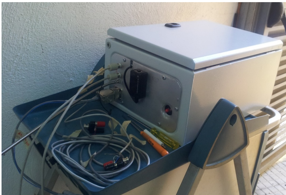
Fig. 4: Contenitore ATEX all'interno del quale è posizionato il sistema ODC con la ruota porta-filtri.
