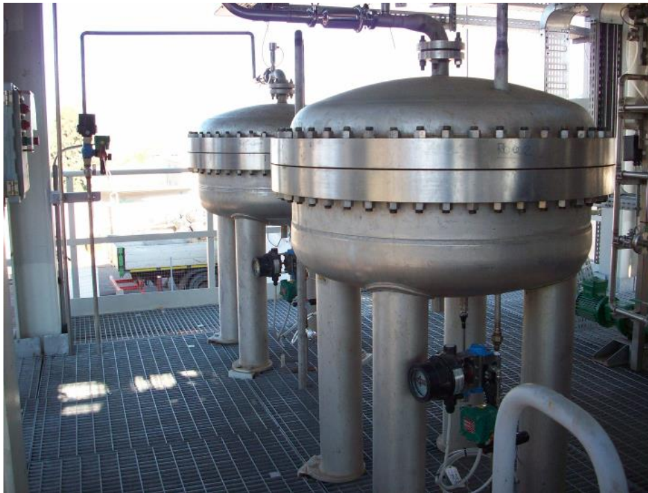
Figura 7. Reattori di assorbimento dell'anidride carbonica RO001 e RO002
