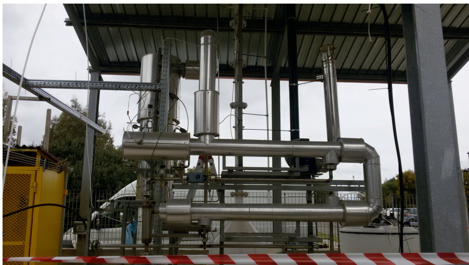
Figure 6 Vista frontale dell'impianto IOSTO
