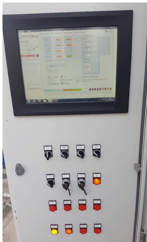
Figure 16 Quadro elettrico di controllo
