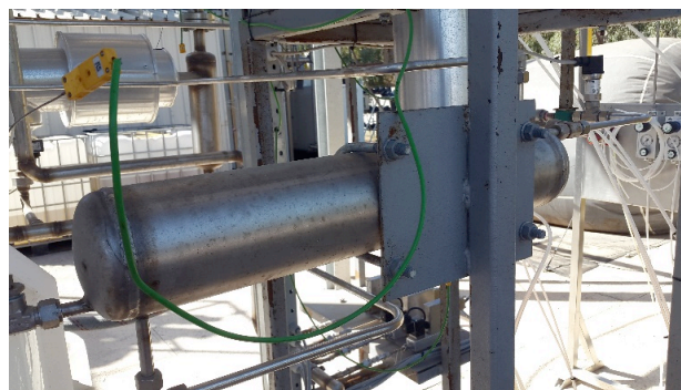
Figure 13 Scambiatore gas-liquido ingresso colonna
