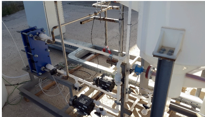
Figure 14 Scambiatore a piastre e pompe rilancio
