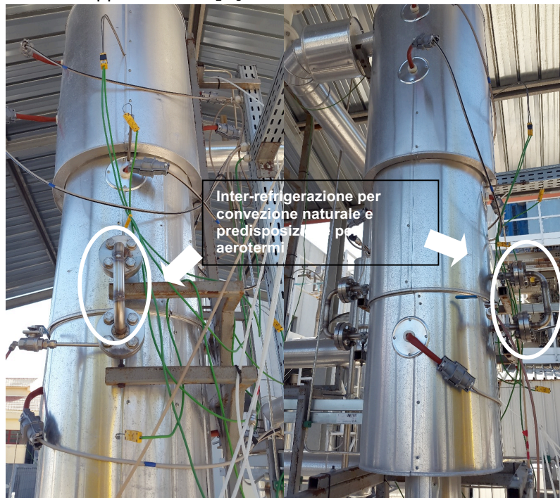
Figure 11 Reattore catalitico (particolare interrefrigerazione)
