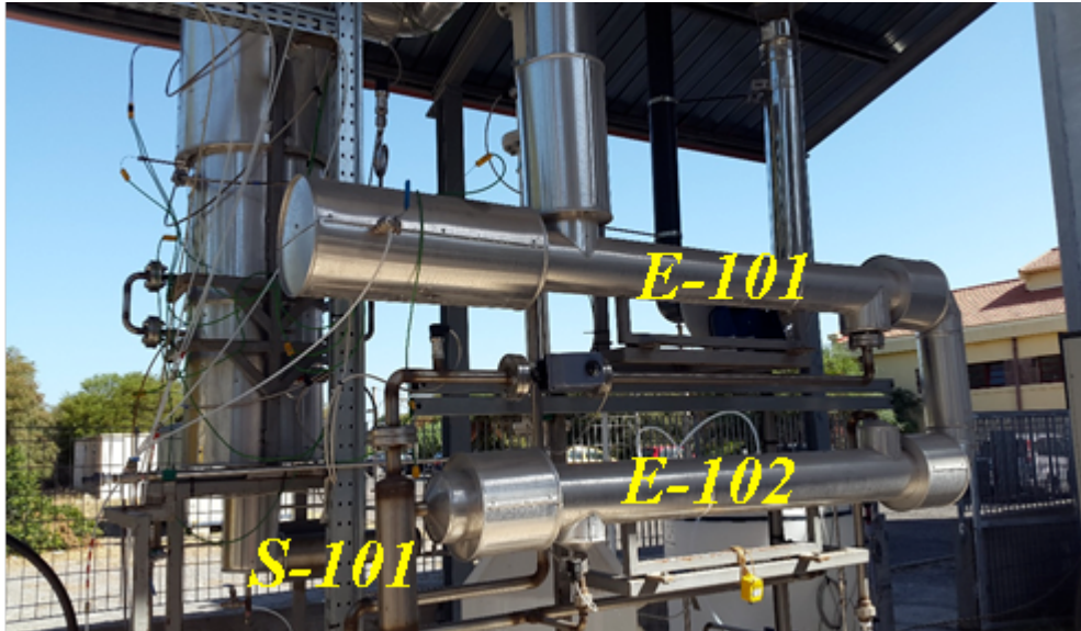
Figure 10 Vista della sezione di disidratazione
