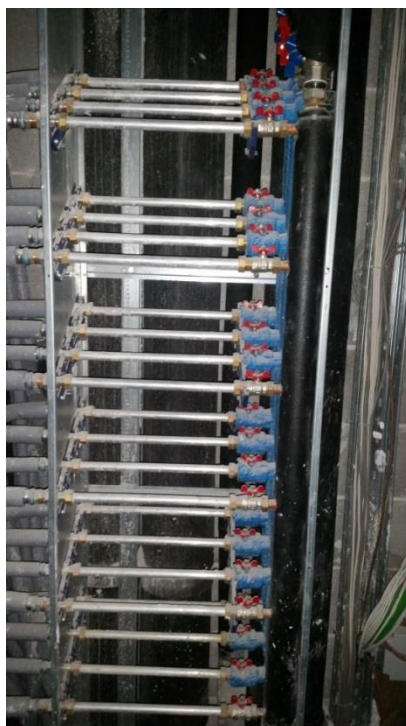
Figura 116. Stacchi dell'impianto termico e a dx canalizzazione per dorsali di edificio
