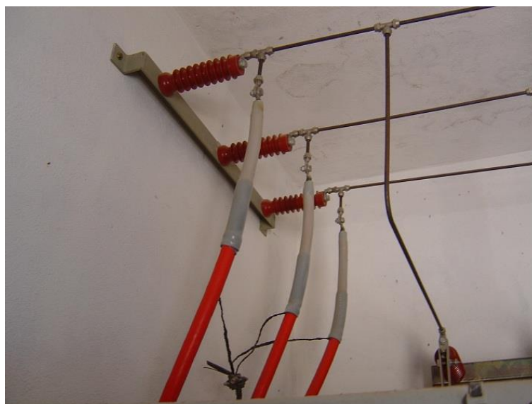
Figura 34. Derivazione in cavo MT da sbarre a 10kV all'interno di una cabina di distribuzione SE.LI.S.
