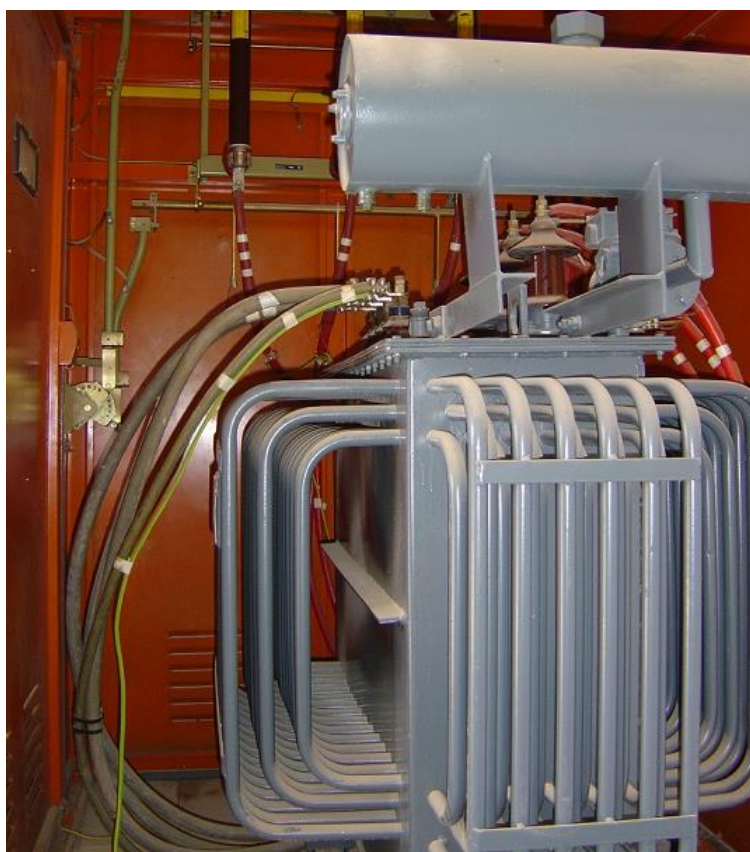
Figura 33. Trasformatore in olio 10/0,4 kV/kV all'interno di una cabina di distribuzione SE.LI.S.
