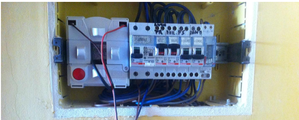
Figura 25. Quadri elettrici dell'abitazione e sistema di monitoraggio installato.
