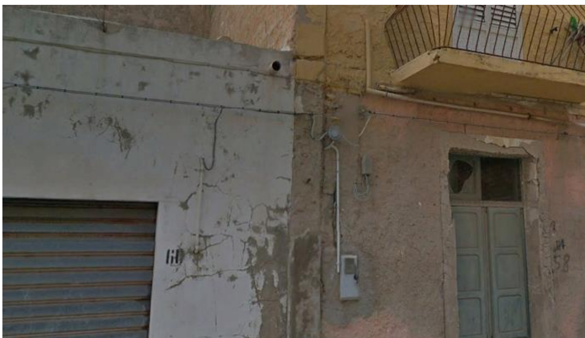
Figura 37. Particolare di linea in cavo aereo BT all'interno del centro urbano di Lampedusa.
