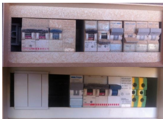
Figura 26. Quadri elettrici della villetta.
