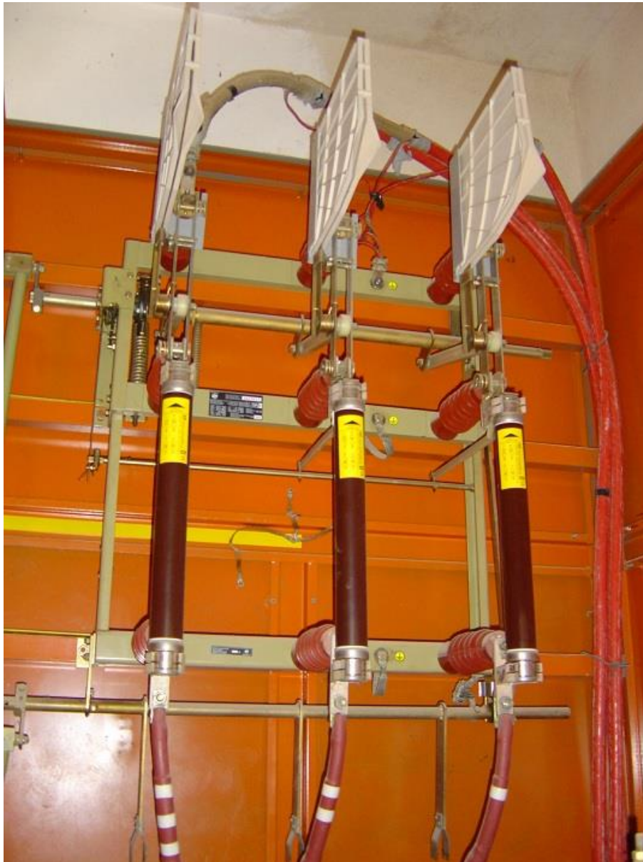
Figura 35. Interruttori MT in aria a 10kV all'interno di una cabina di distribuzione SE.LI.S.
