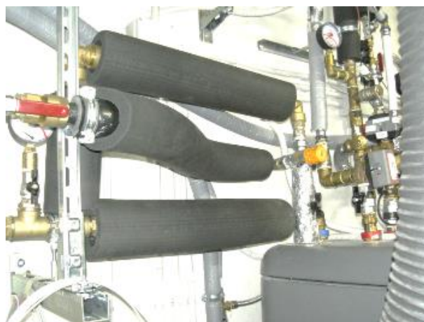
Figura 7. Tubi rettilinei termicamente isolati in corrispondenza dei misuratori di energia termica nei circuiti idronici.
