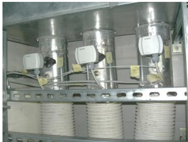
Figura 6. Sensori di temperatura e umidità relativa in canali d'aria all'uscita dello scambiatore di calore interrato
