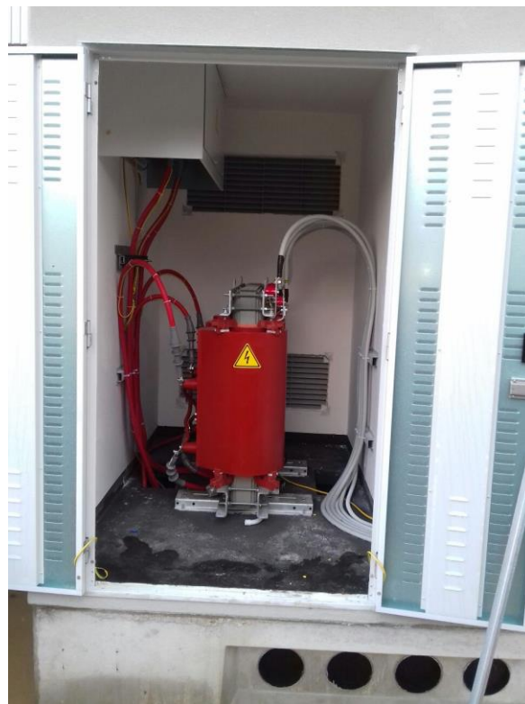
Figura 98. Particolare del vano conil trasformatore da 400 kVA.
