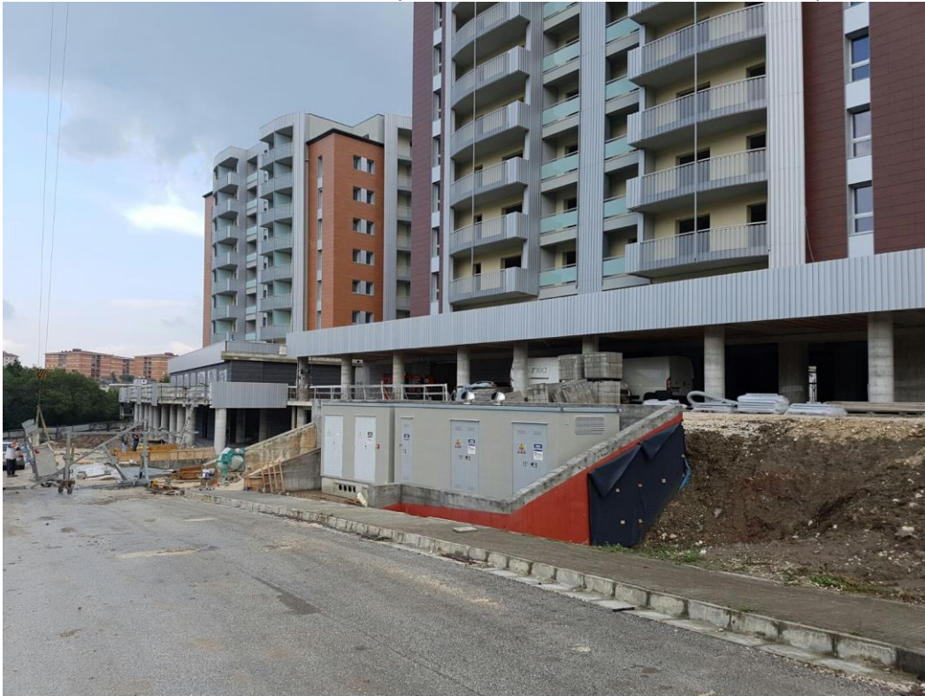
Figura 96. Cabina di consegna e di trasformazione.
