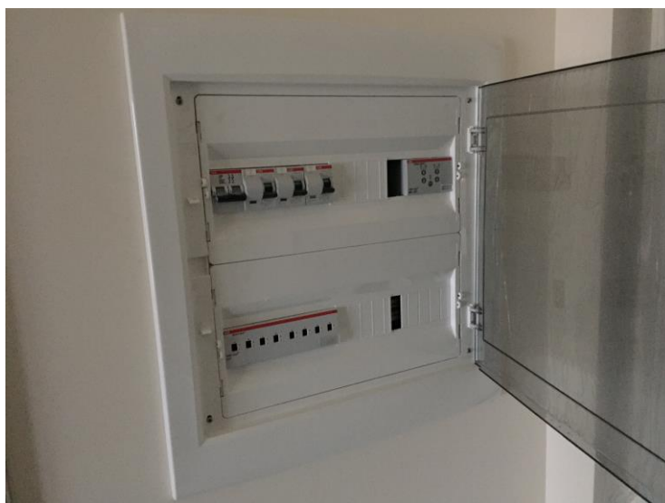
Figura 81. Quadro elettrico/domotico di unità.
