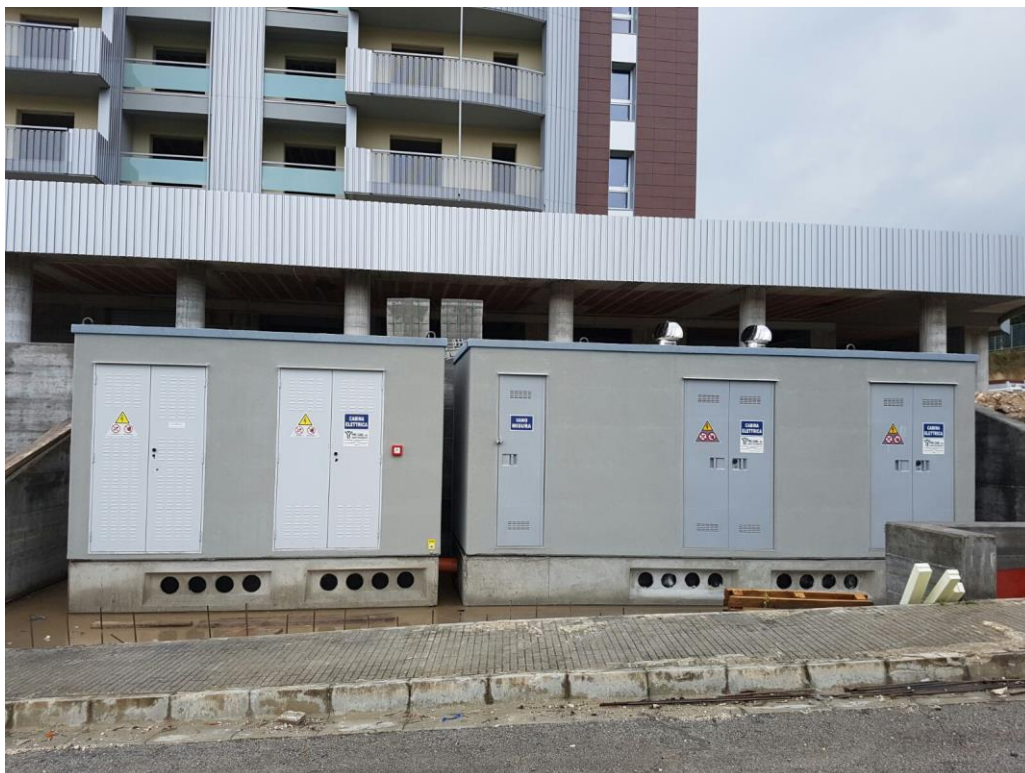
Figura 97. Particolare delle cabine. A sinistra vano trasformatore e quadro di media tensione di proprietà. A destra vano misura e vano di consegna del distributore.
