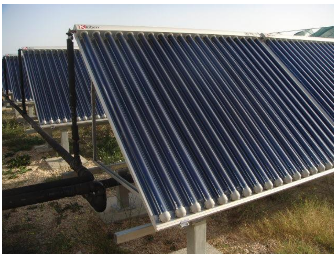
Figura 2.2.6: Collettori solari dell'impianto di solar cooling presso l'Università di Bari.
