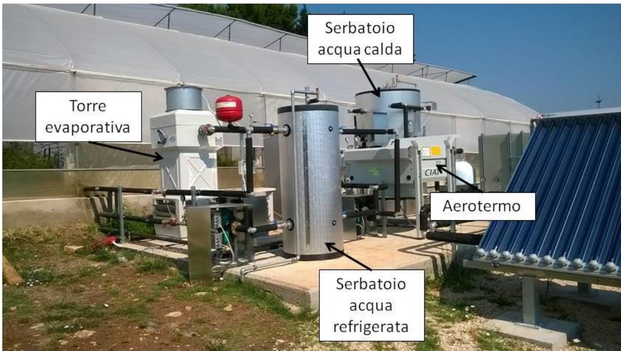
Figura 2.2.7:Macchine dell'impianto di solar cooling presso l'Università di Bari.
