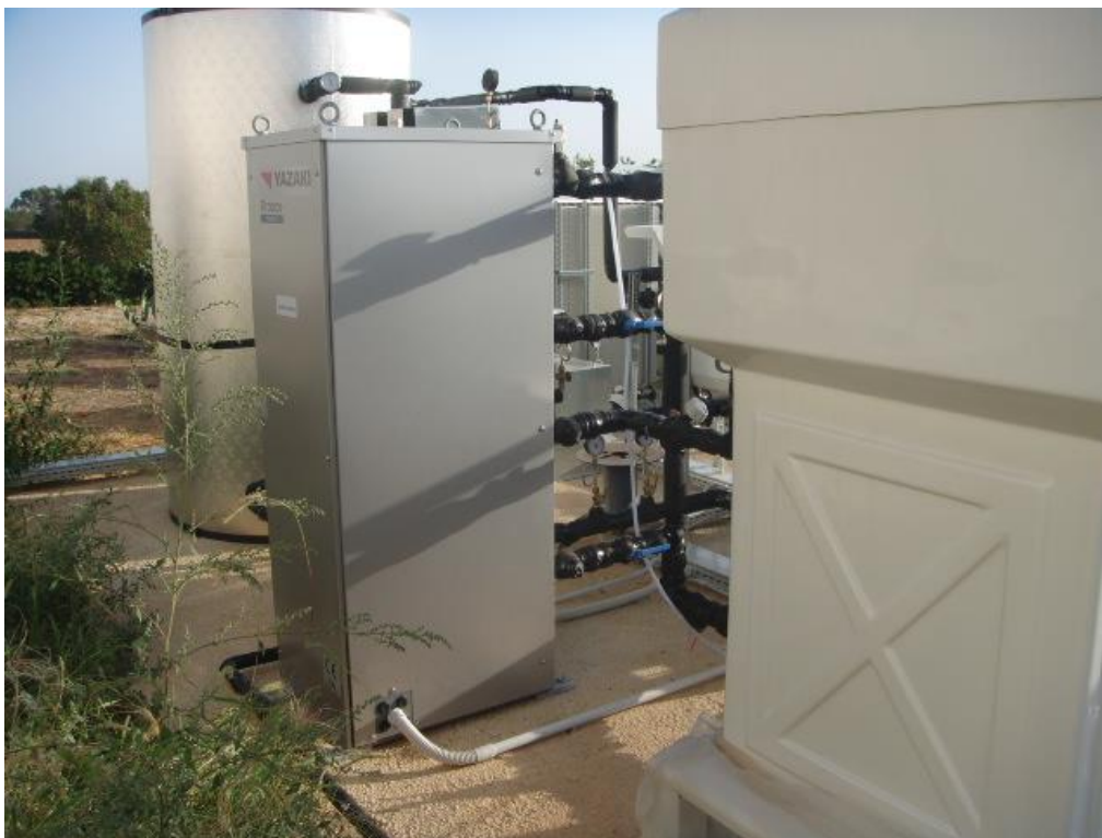
Figura 2.2.15: Chiller ad assorbimento (Yazaki WFC-SC 5) dell'impianto di solar cooling presso l'Università di Bari.
