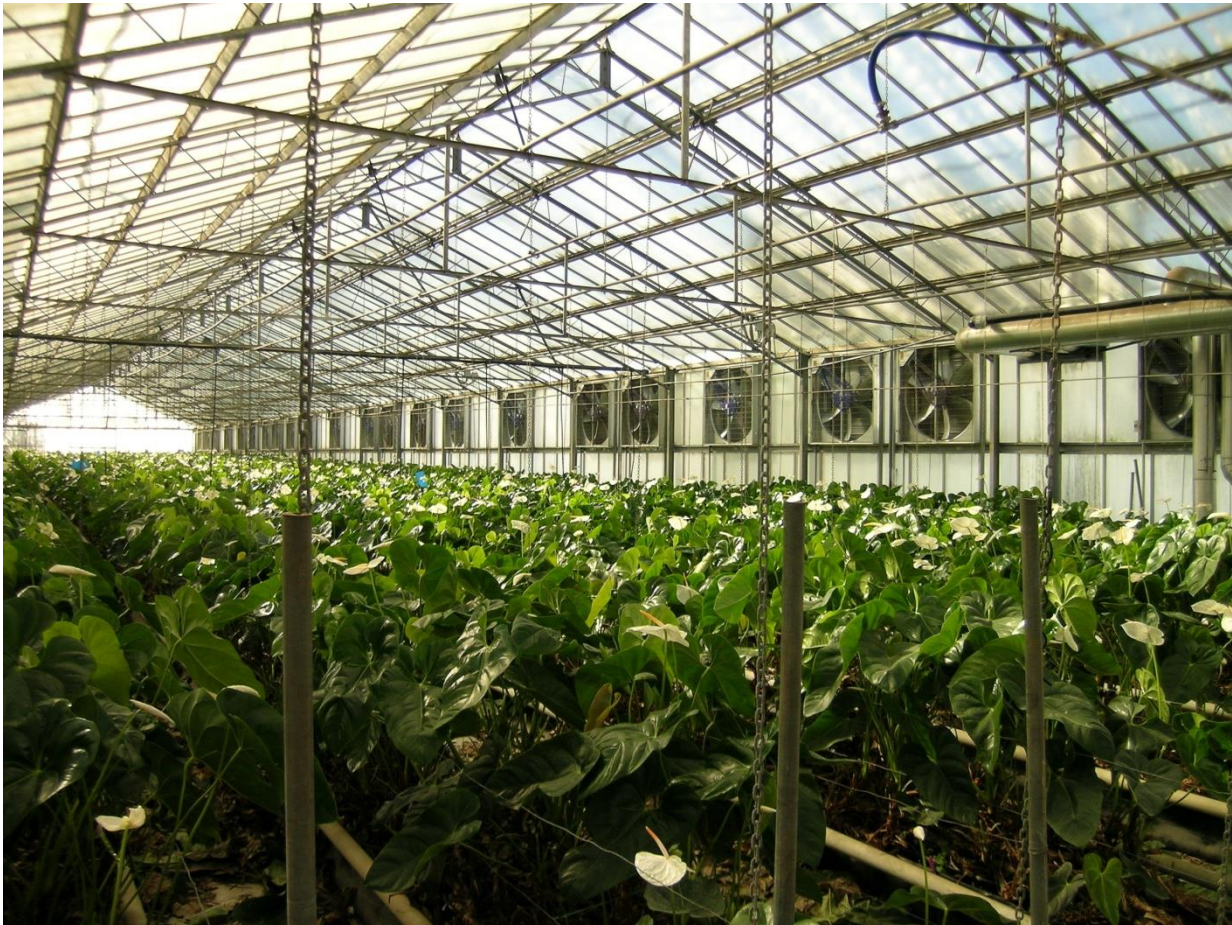
Figura 1.2.2: Ventilatori di aspirazione in un sistema di raffreddamento a filtri evaporativi.
