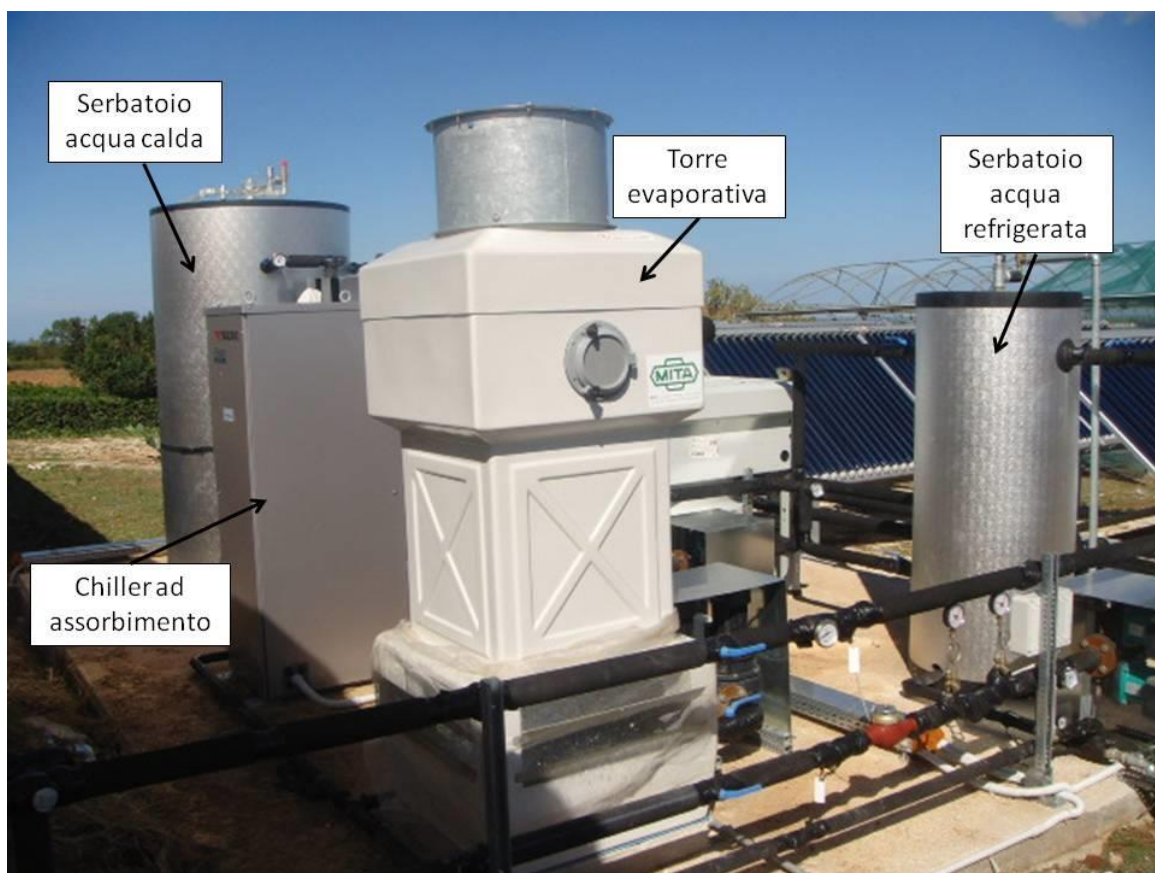
Figura 2.2.8: Particolare delle macchine dell'impianto di solar cooling presso l'Università di Bari.
