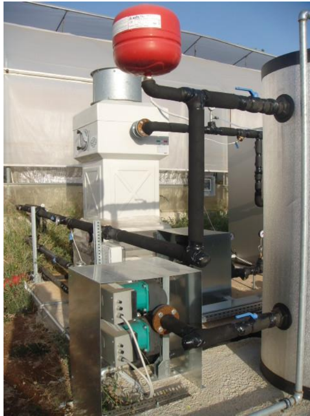
Figura 2.2.14: Torre evaporativa dell'impianto di solar cooling presso l'Università di Bari.
