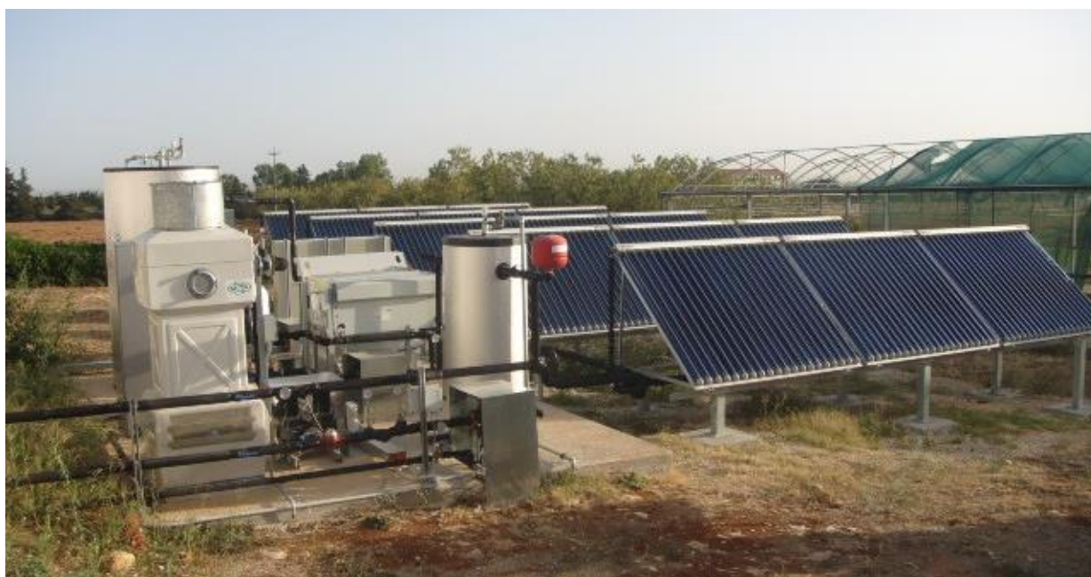
Figura 2.2.5: Impianto di solar cooling presso il centro l'Università di Bari.
