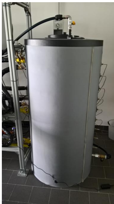
Figura 19. Serbatoio di accumulo termico
