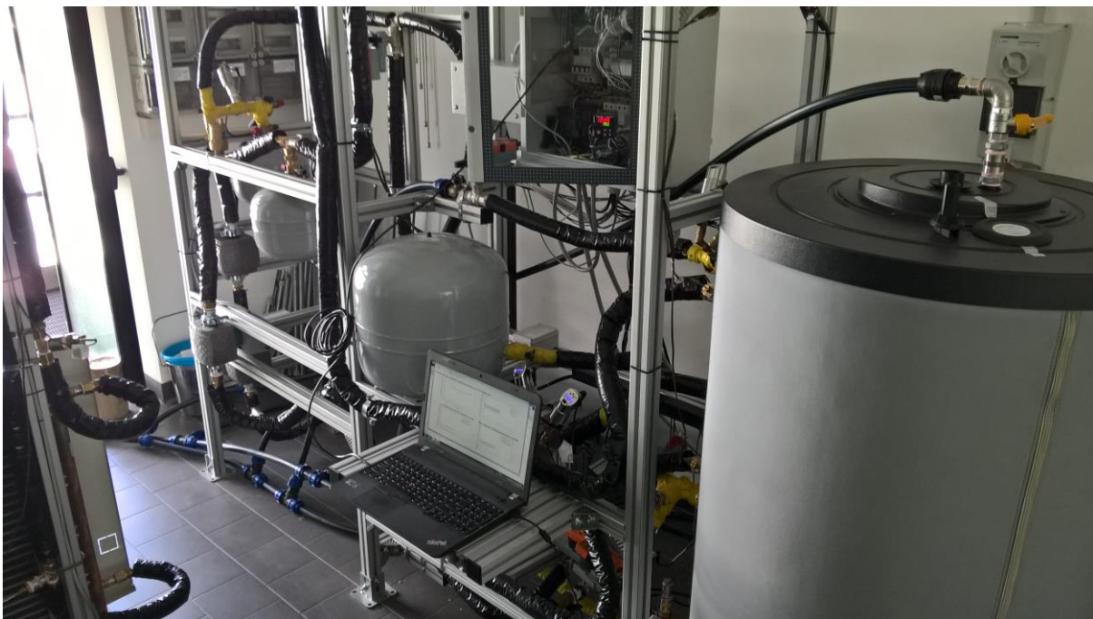
Figura 18. Impianto sperimentale utilizzato per l'implementazione del modello di ottimizzazione
