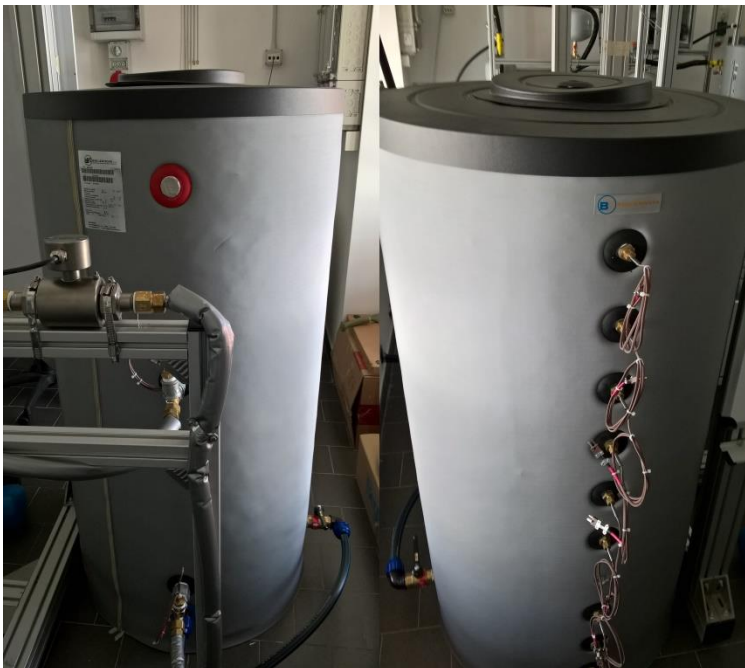
Figura 22. Serbatoio di accumulo del freddo con acqua e PCM macro-incapsulato.
