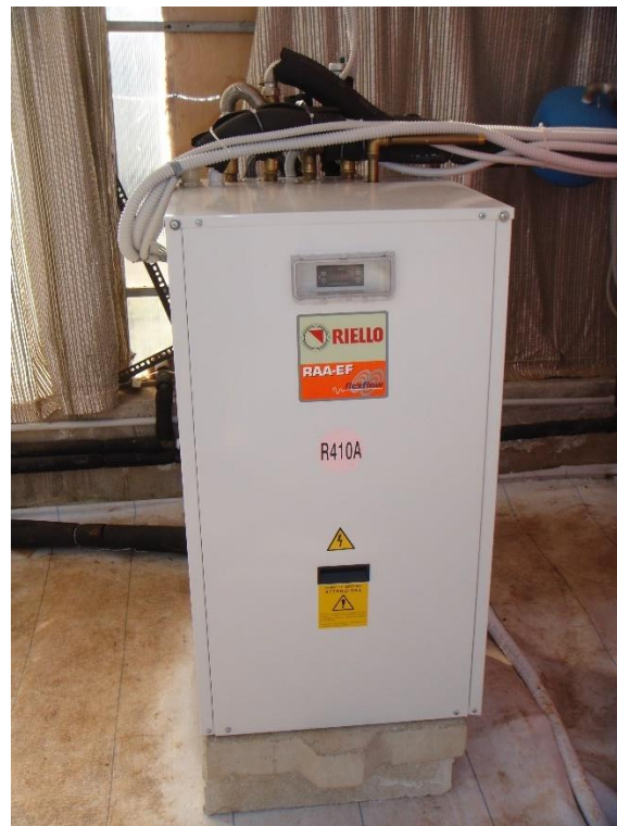
Figura 20: Pompa di calore geotermica all'interno di una serra presso il campo sperimentale dell'Università di Bari
