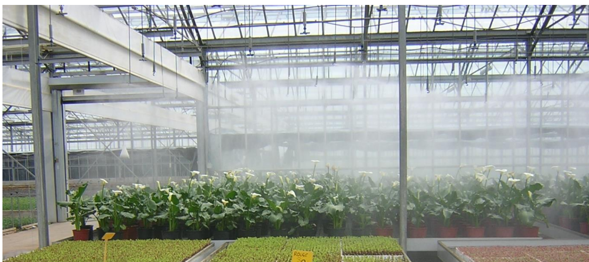
Figura 26: Sistema Fog ad evaporazione d'acqua utilizzato per il raffrescamento di una serra.
