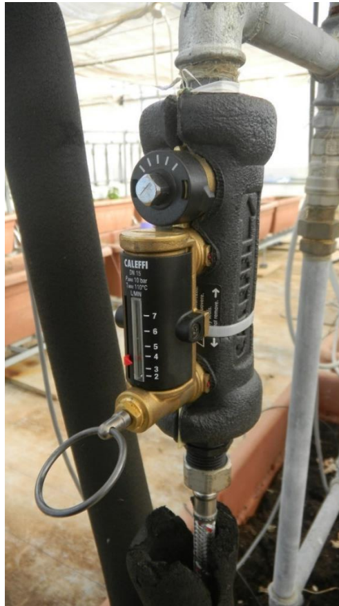
Figura 30: Regolatore di portata installato all'ingresso delle linee principali di raffreddamento posizionate sui vasi per coltivazione.
