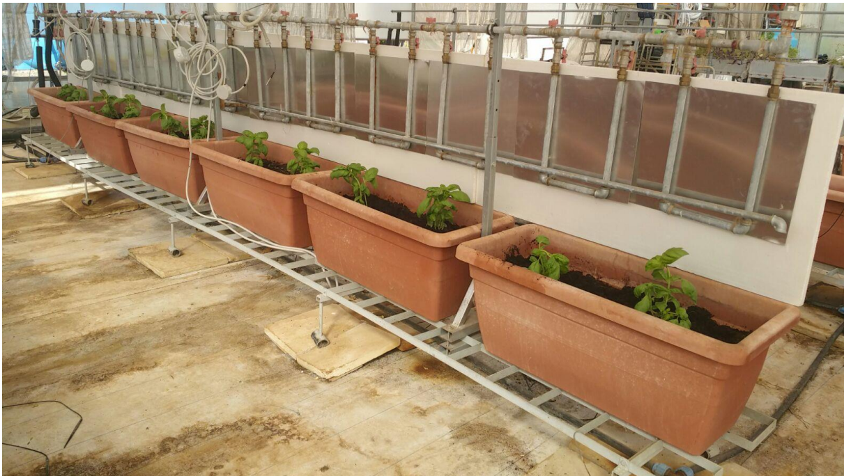
Figura 32: Sistema di tubi di raffreddamento posizionati in corrispondenza del bordo dei vasi di coltivazione e posti in contatto con le superfici metalliche di raffreddamento.
