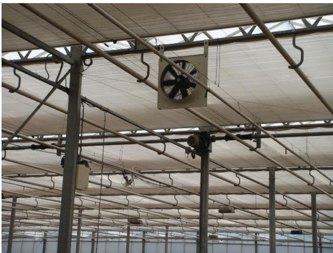
Figura 9: Interno di una serra floricola in Puglia: destratificatore, impianto di illuminazione, motore per l'apertura e chiusura degli schermi termici.
