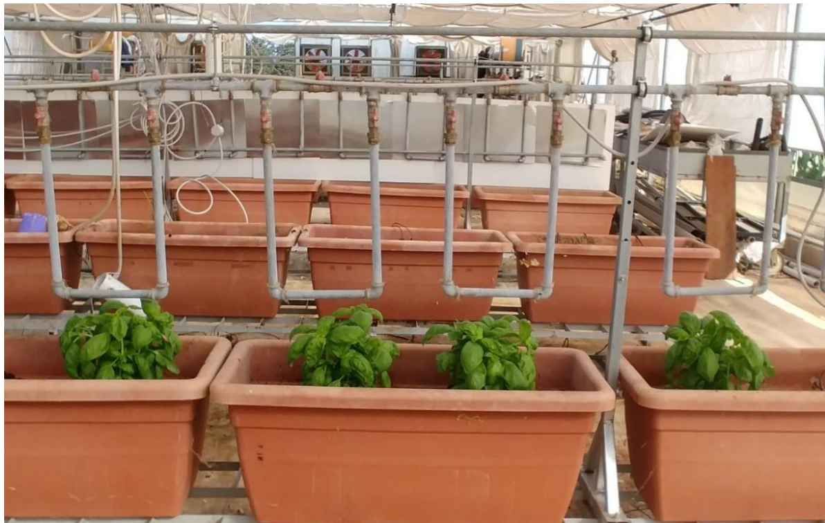
Figura 31: Sistema di tubi di raffreddamento installati in posizione centrale sui vasi di coltivazione.
