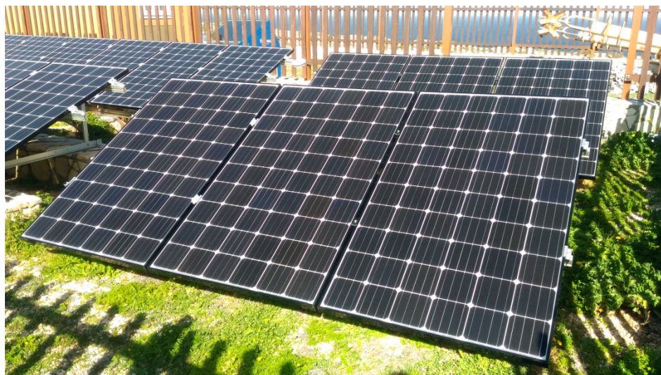
Figura 90. Impianto per lo studio dell'effetto della deposizione sulla produzione dei pannelli fotovoltaici. I tre pannelli posteriori vengono puliti regolarmente, mentre quelli anteriori sono stati puliti solo all'inizio dell'esperimento.
