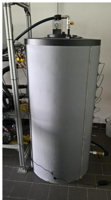
Figura 19. Serbatoio di accumulo termico
