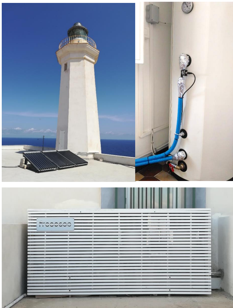
Figura 31 Foto del sistema di climatizzazione freescool con produzione di acqua calda sanitaria presso il centro di ricerche ENEA al faro di Grecale a Lampedusa
