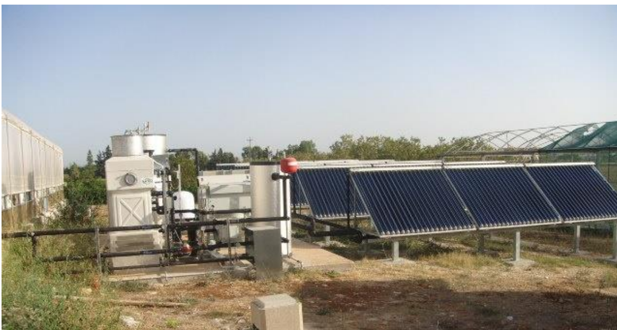
Figura 26: Impianto di solar cooling composto da campo solare, assorbitore, torre evaporativa, serbatoio di accumulo caldo e serbatoio di accumulo freddo, presso il Centro sperimentale "P. Martucci" dell'Università di Bari, Valenzano (BA).
