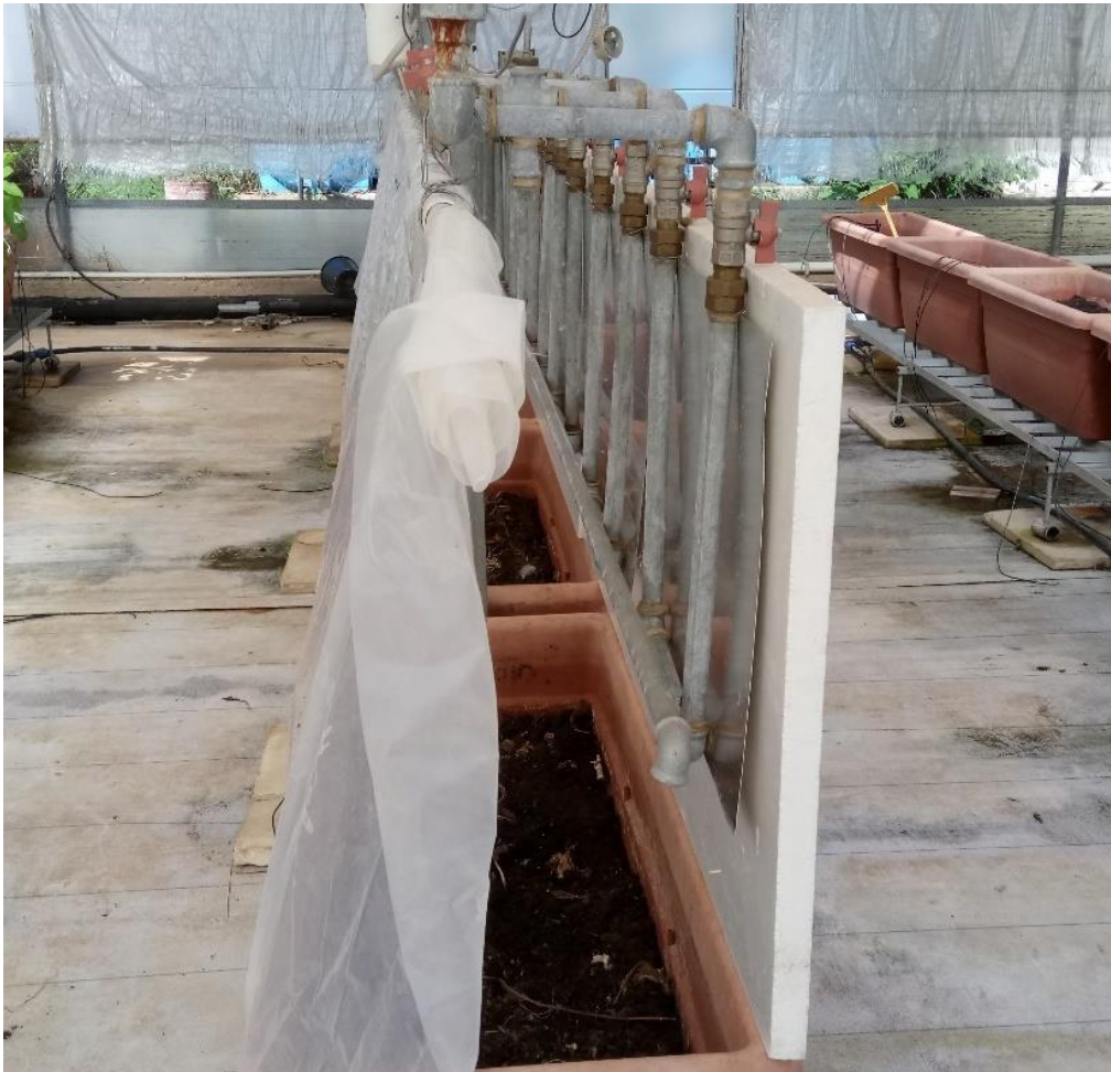
Figura 28: Sistema di tubi e piastre di raffreddamento con chiusura in film plastico della zona di coltivazione, vista laterale.
