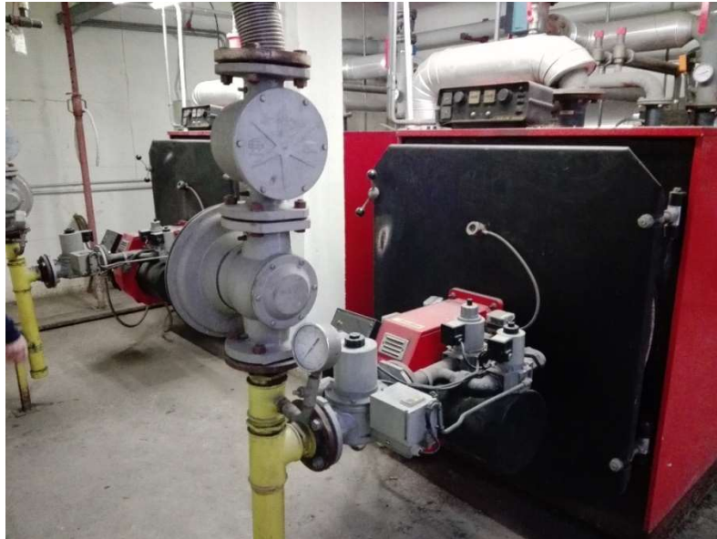
Figura 4.9. Locale centrale termica
