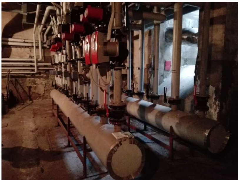
Figura 4.10. Collettori di distribuzione dell'impianto di riscaldamento
