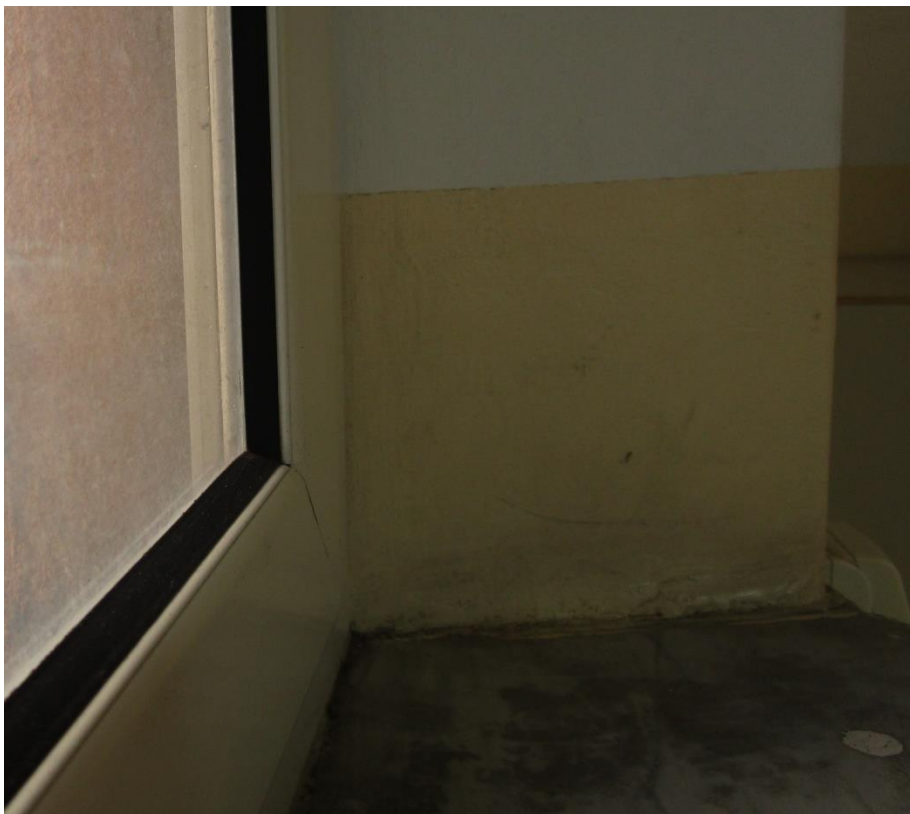
Figura 8: Degrado all'interno della scuola L. Tempesta
