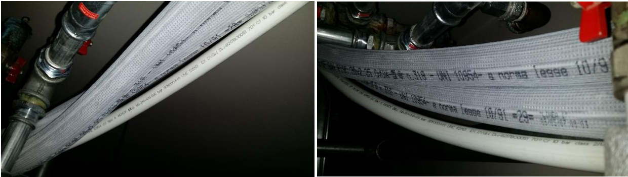
Figura 24: Coibentazione della tubazioni
