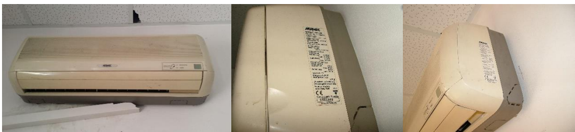
Figura 15: Sistemi monosplit per la Presidenza - Segreteria
