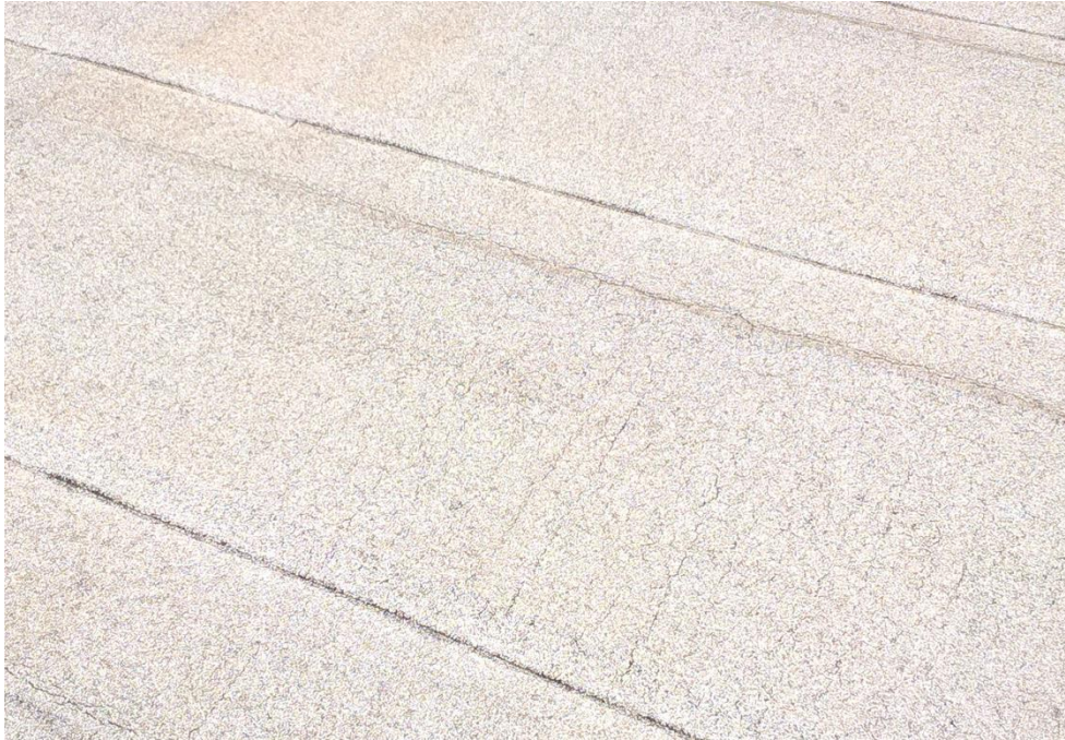
Figura 130: Attuale finitura della copertura a terrazza
