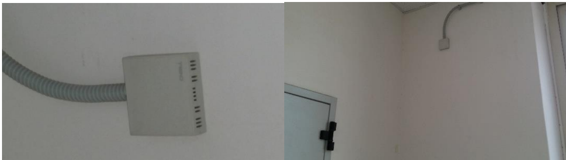
Figura 22: Termostato di Zona
