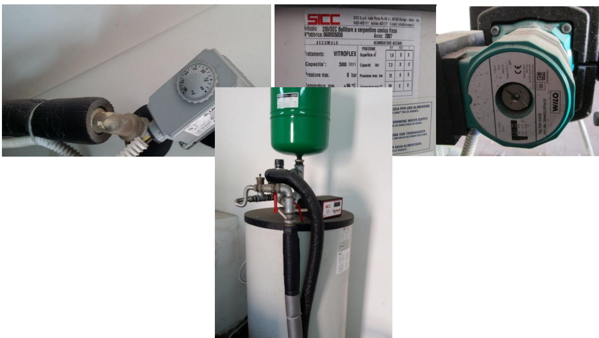
Figura 30: Sistema di accumulo dell'acqua calda
