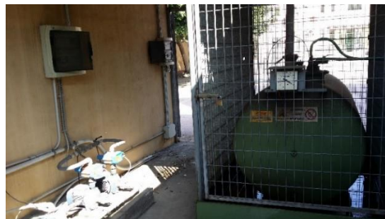
Figura 26: Serbatoio del gasolio
