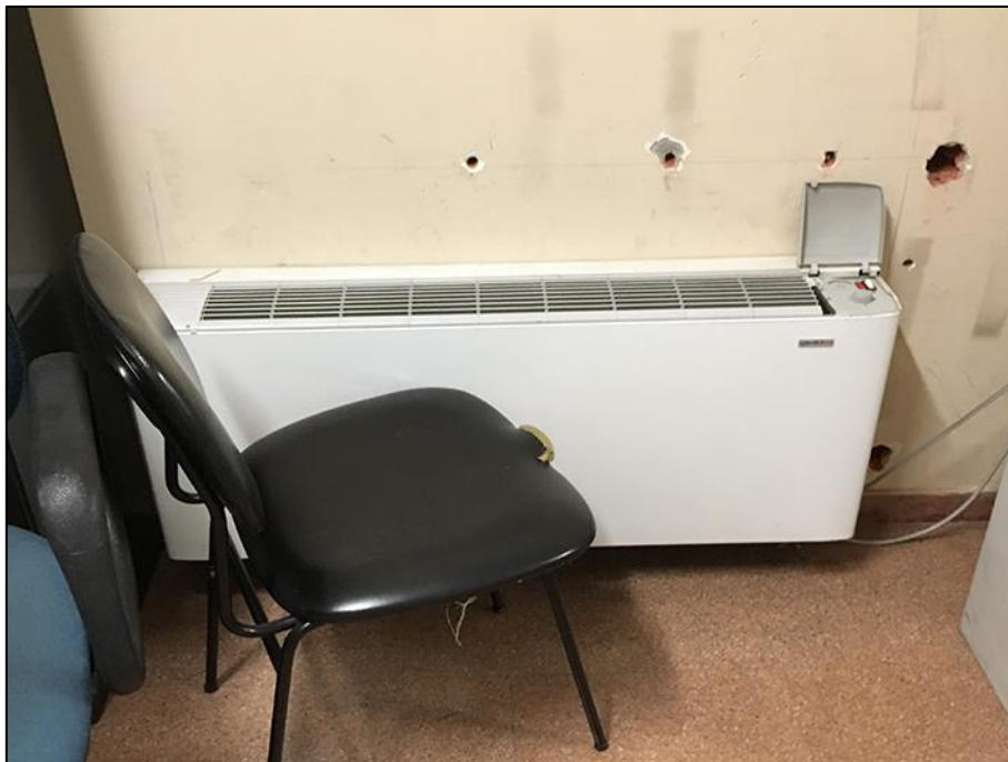
Figura 4.13. Ventilconvettore di recente sostituzione.
