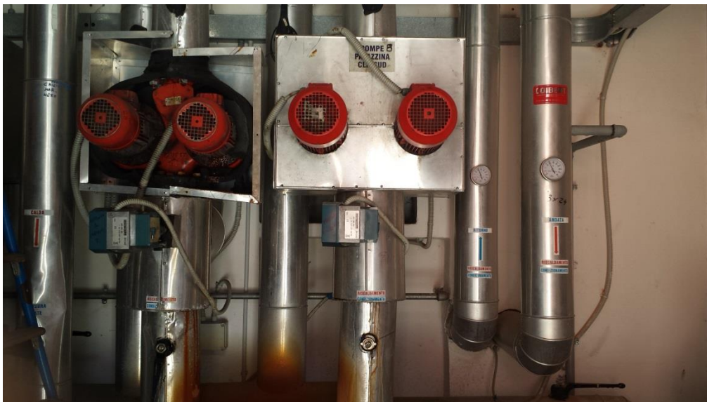
Figura 11: Pompe di distribuzione del sistema di riscaldamento.
