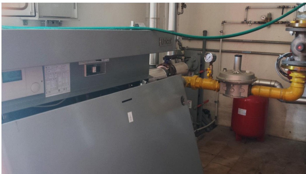
Figura 12: Locale tecnico per la caldaia.
