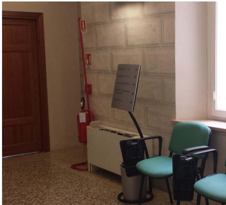
Figura 10: Fan coil per il riscaldamento e raffrescamento delle stanze in Palazzo A10.
