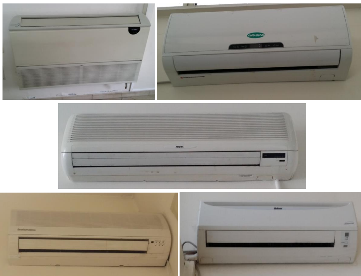
Figura 16. Immagini di alcuni condizionatori presenti nei locali
