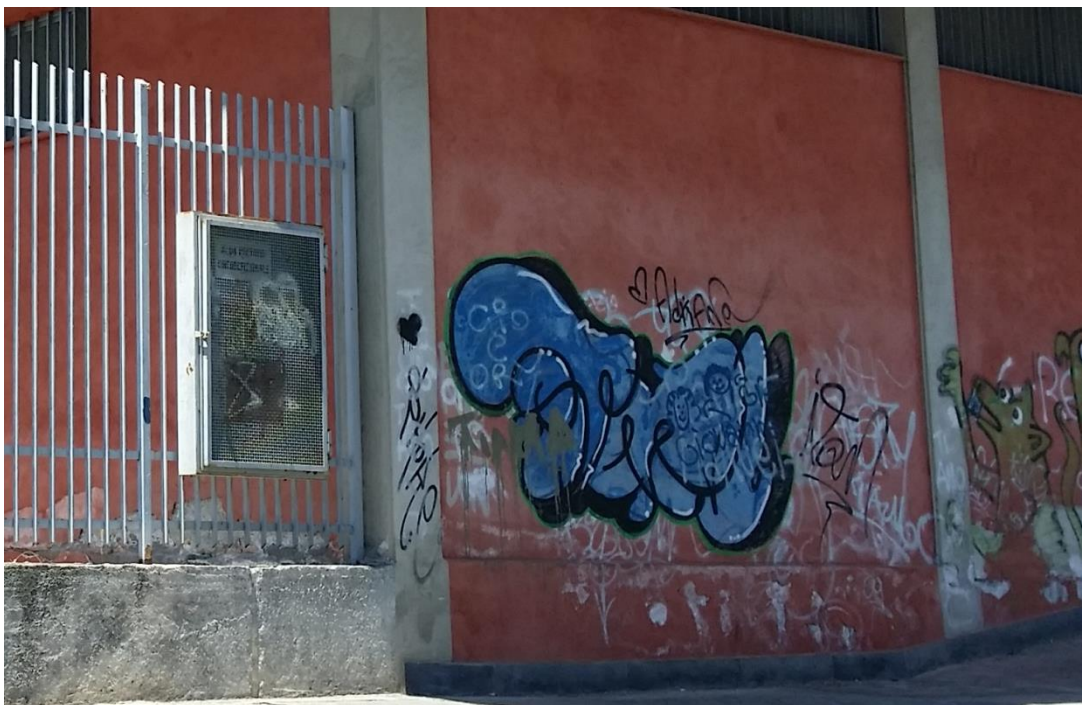
Figura 8. Degrado antropico sulle pareti esterne dell'edificio
