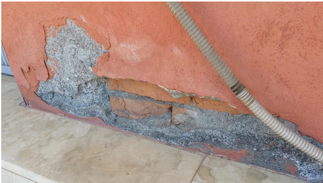
Figura 7. Distacco dell'intonaco dovuto all'umidità ascendente
