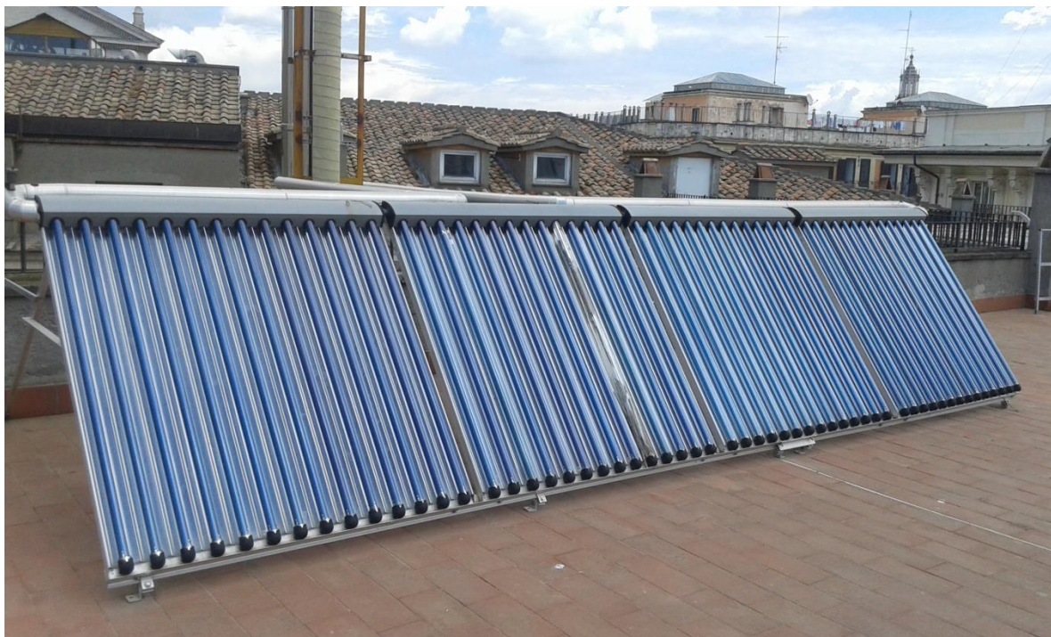
Fig. 8: Collettori solari presenti in copertura
