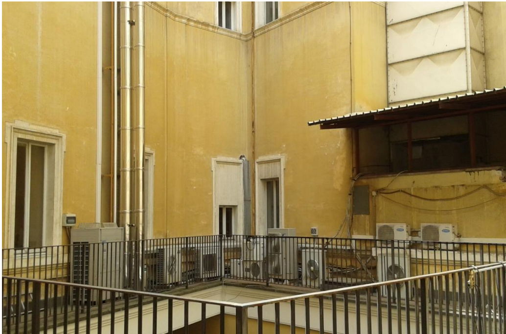
Fig. 6: Unità Esterne climatizzazione
