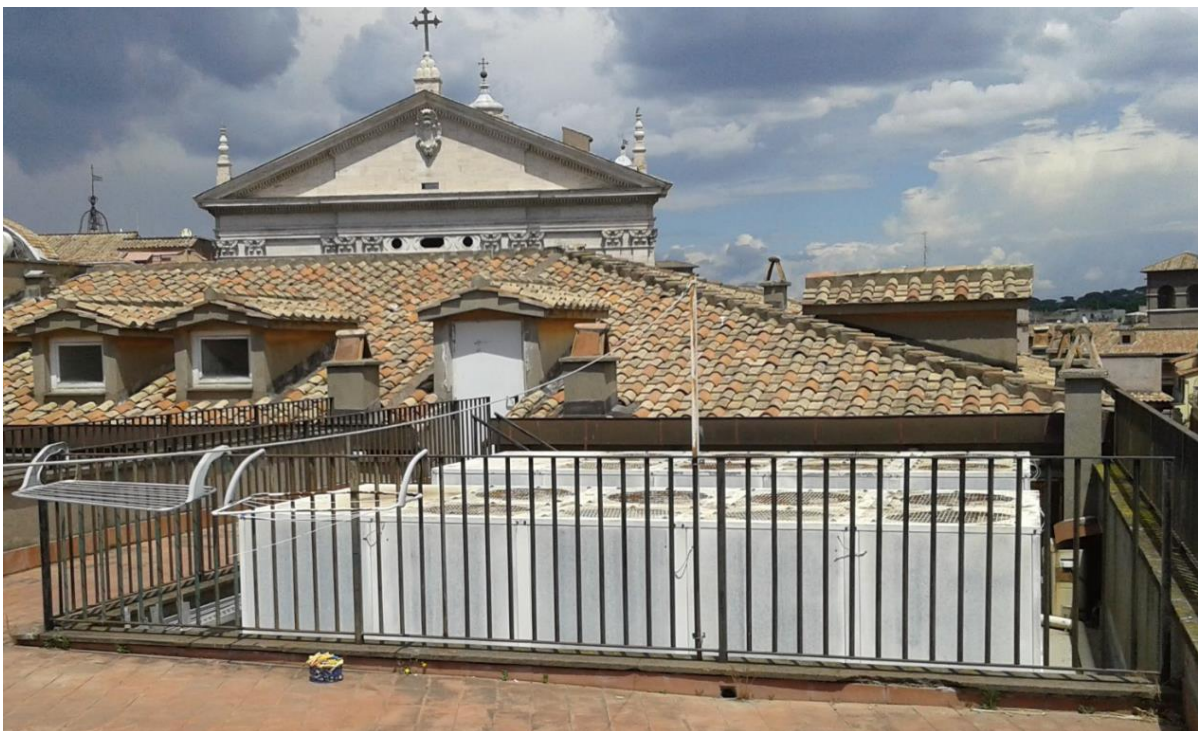
Fig. 7: Chiller dell'UTA presente in copertura
