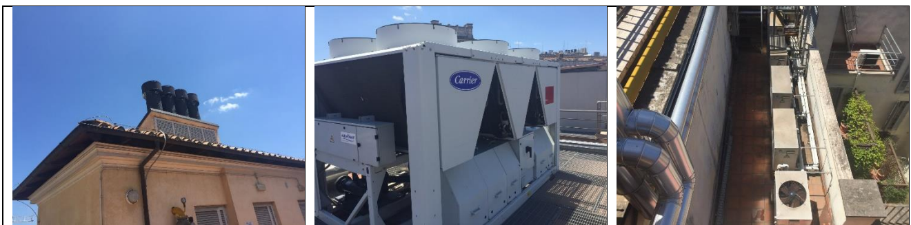
Figura 8.7 – Vista della centrale termica, di una delle pompe di calore e delle unità esterne dell'impianto VRF
