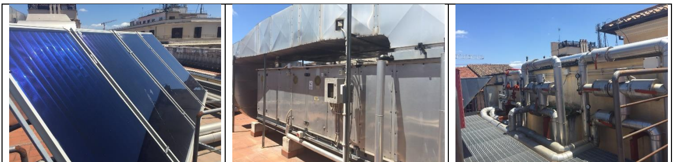
Figura 8.8 – Vista dei collettori solari, dell'unità di trattamento aria al servizio degli Uffici B- C –D e del relativo sistema di regolazione
