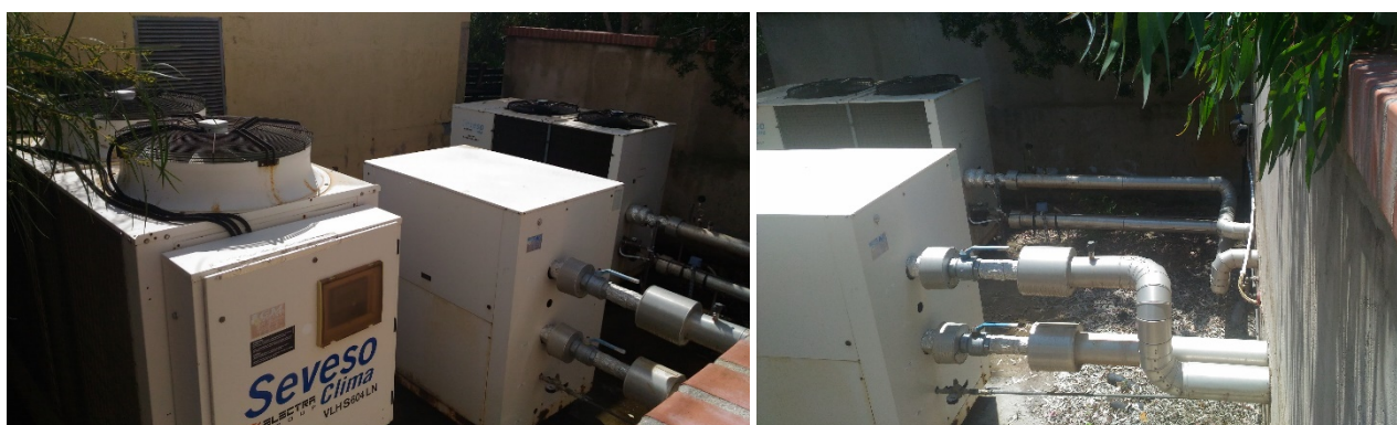
Figura 28. Generatori a pompa di calore e "gruppo pompe" (al centro)
