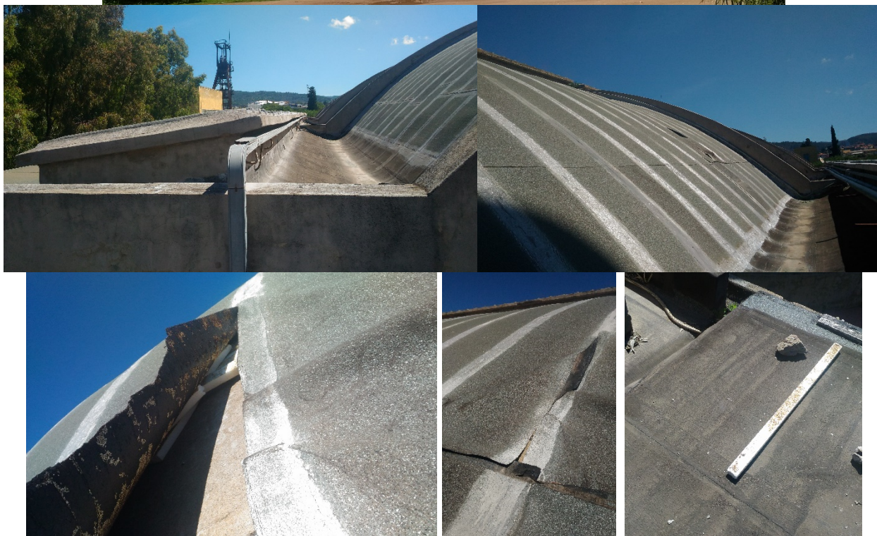
Figura 12. Copertura a volta, e particolari del degrado della impermeabilizzazione e dello stato isolante.
