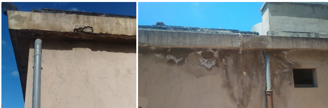
Figura 11. Degrado associato alle infiltrazioni di acqua meteorica nelle coperture piane
