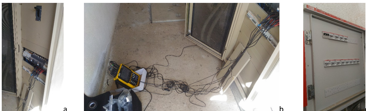
Figura 39. quadri generali: a-b) quadro dell'alimentazione della climatizzazione e misuratore Chavin Arnoux CA8336; c) quadro di alimentazione degli aspiratori della zona espositiva
