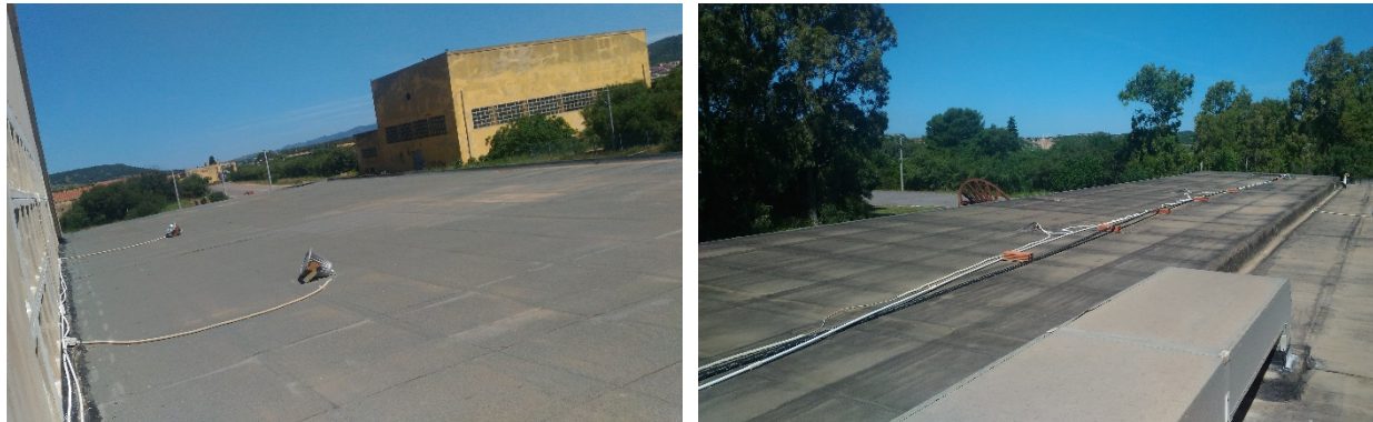
Figura 10. Copertura piane del CF_3 in guaina ardesiata, e del CF_2 in guaina bitumata
