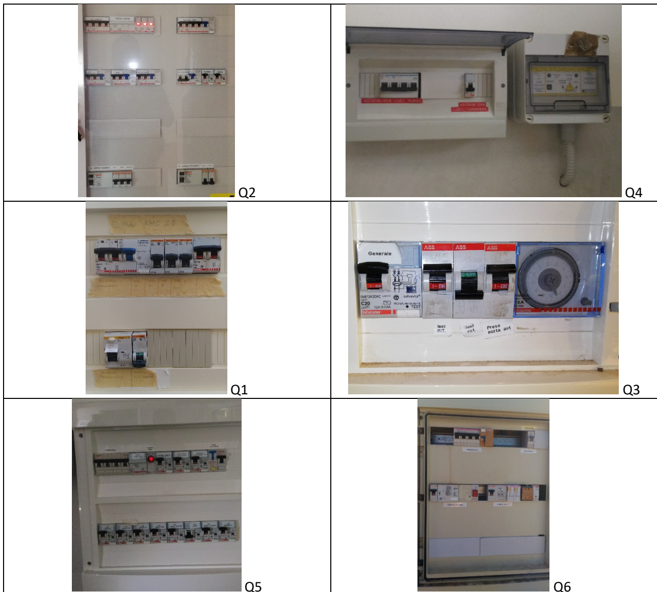
Figura 38. Altri quadri elettrici
