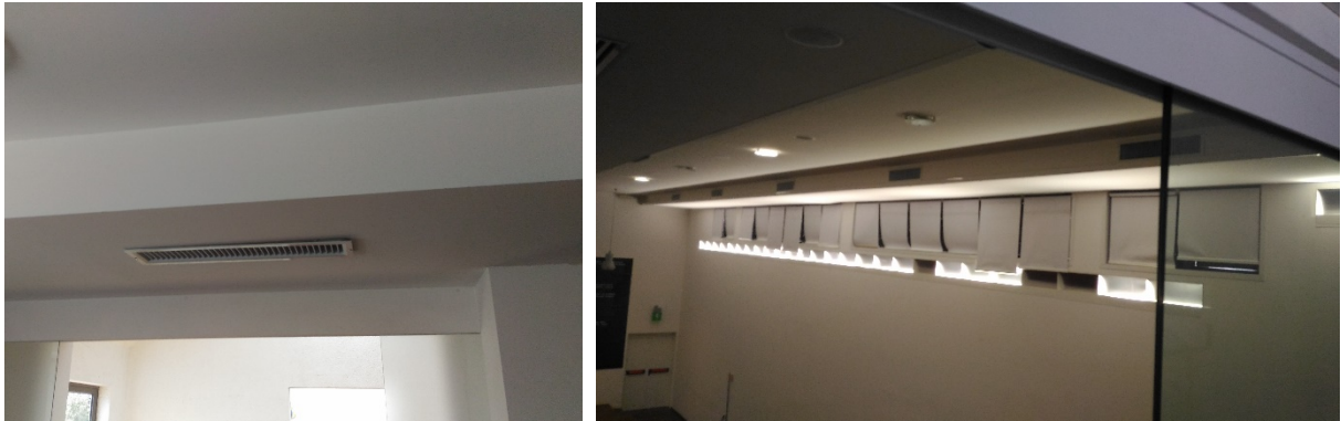
Figura 31. Canalizzazioni interne di distribuzione dell'aria nella zona conferenza (UTA_2)
