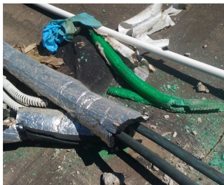
Figura 34. Distribuzione secondaria verso il VC del deposito, con isolamento fortemente compromesso
