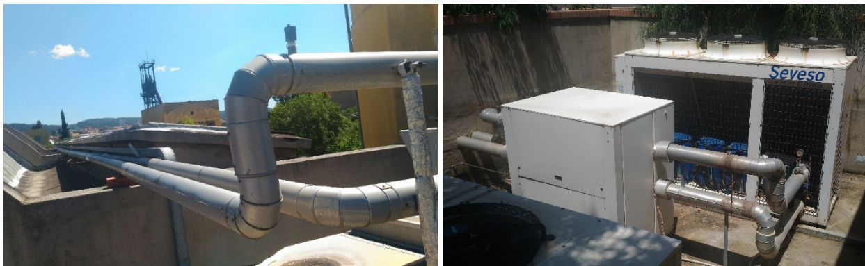
Figura 33. Distribuzione del fluido termovettore verso la UTA_2 e Pompa per la distribuzione primaria (HP_2).
