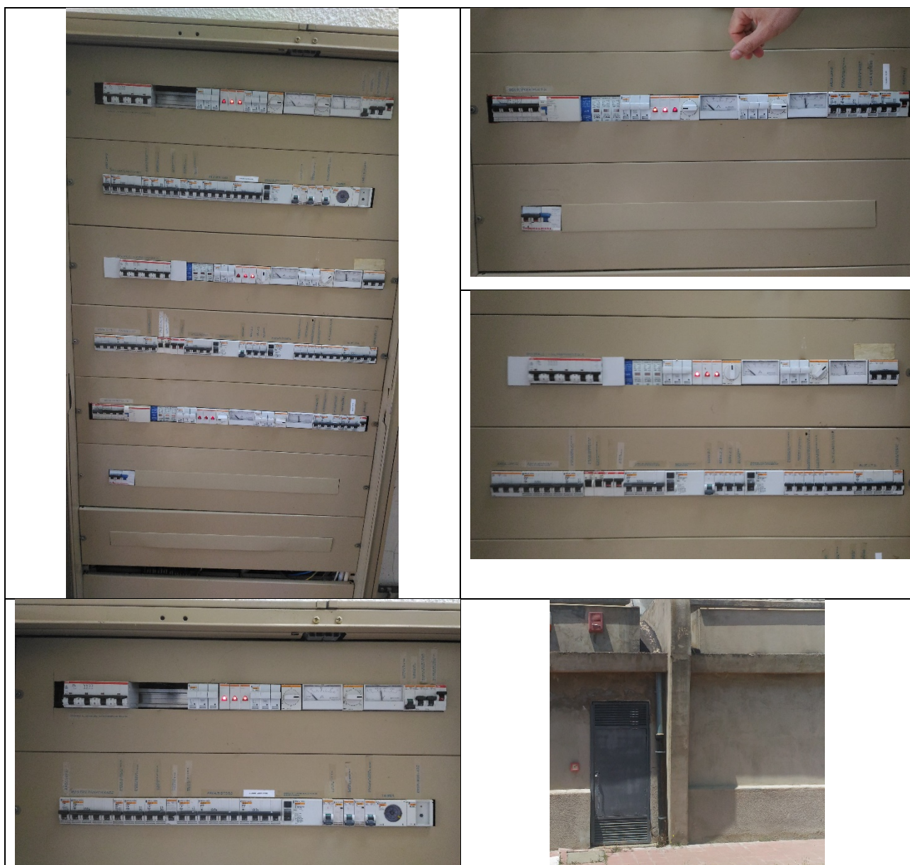
Figura 36. Elementi del Quadro generale ed ingresso della sala quadri
