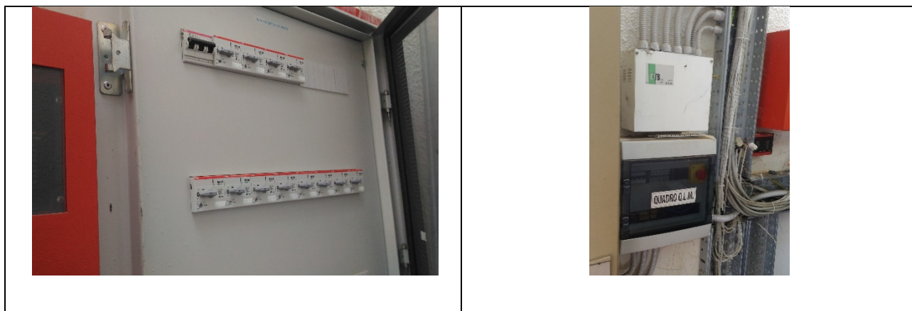
Figura 37. Quadro aspiratori, quadro pompe calore (sala quadri)
