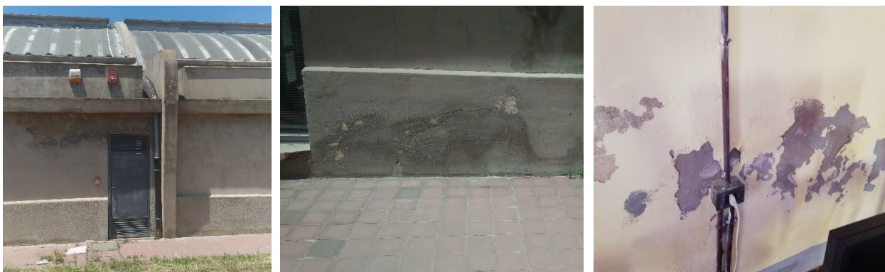
Figura 9. - Nodo pilastro/cordolo/muratura e esempi di fenomeni di risalita capillare
