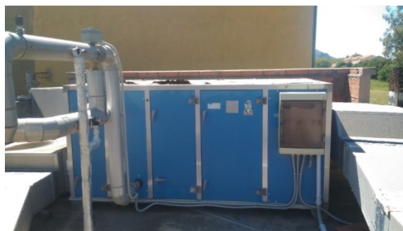
Figura 5.2.2. UTA a servizio della zona commerciale
