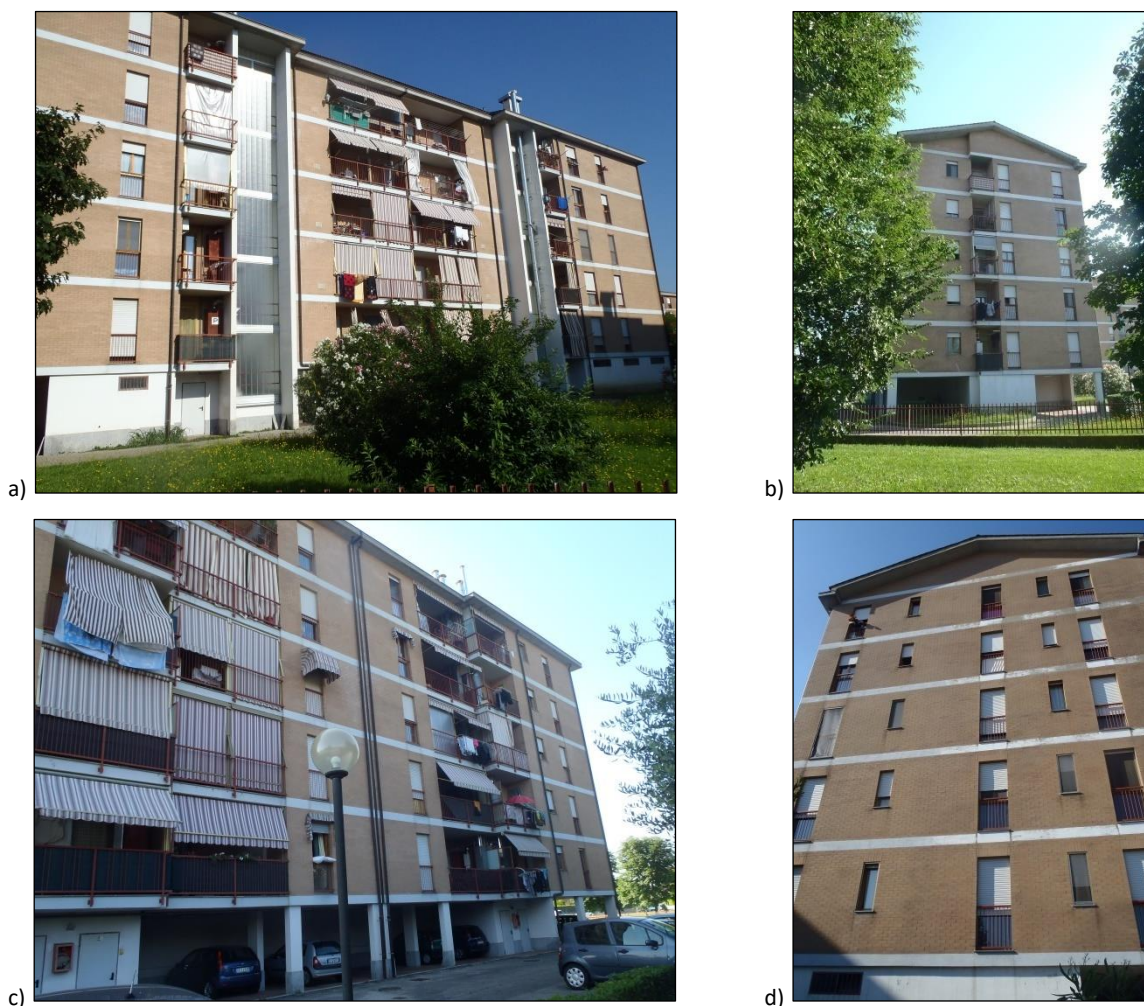
Figura 4.4. Facciate edificio. a) Lotto A - Est; b) Lotto A - Nord; c) Lotto A - Ovest; d) Lotto A - Sud.
