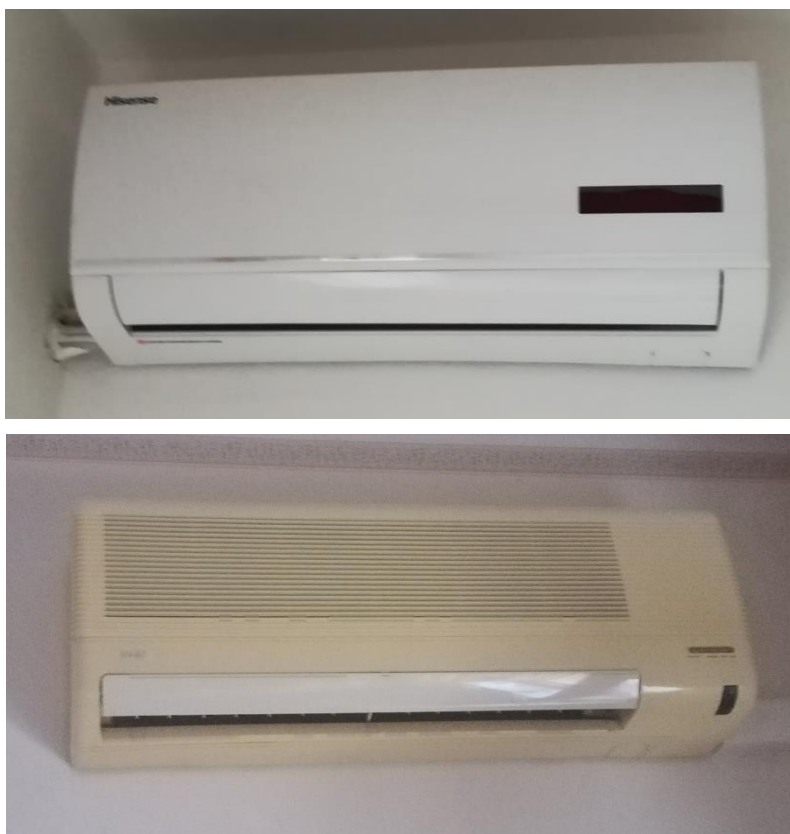
Figura 14. Immagini di alcuni condizionatori split utilizzati
