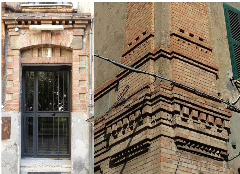
Figura 15: particolari delle soluzioni decorative in laterizio di un portone d'ingresso al fabbricato e una delle cantonate
