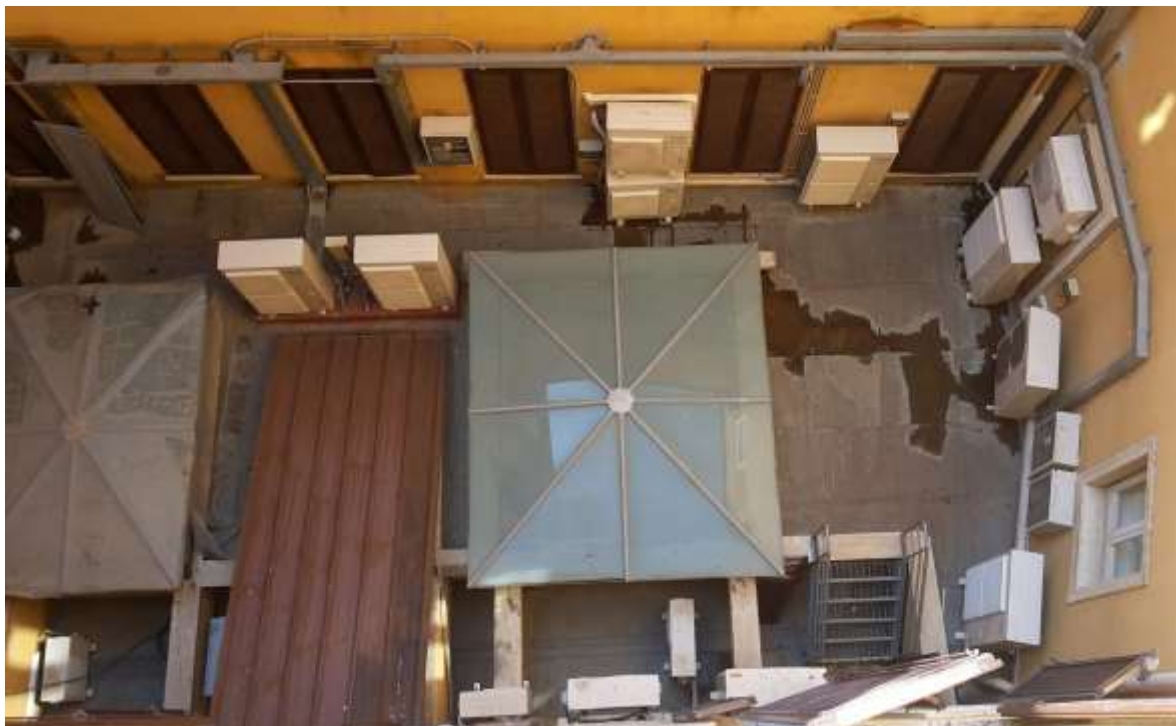
Figura 19: Unità esterne a servizio del CED al primo piano
