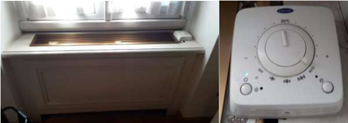
Figura 20: installazione tipo dei ventilconvettori negli uffici con sistema di regolazione a lato macchina
