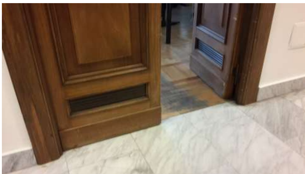
Figura 13: Griglie di transito sulle porte degli uffici climatizzati con impianto ad aria primaria
