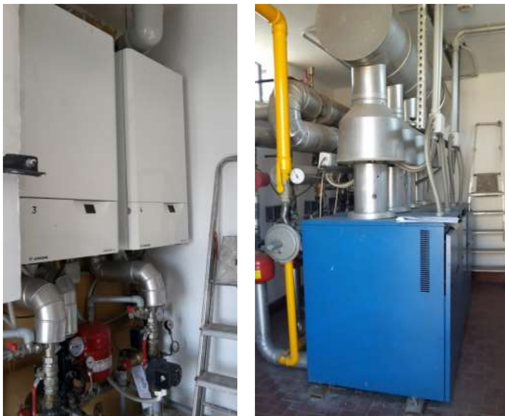
Figura 14: Generatori di calore Junkers e Bongioanni
