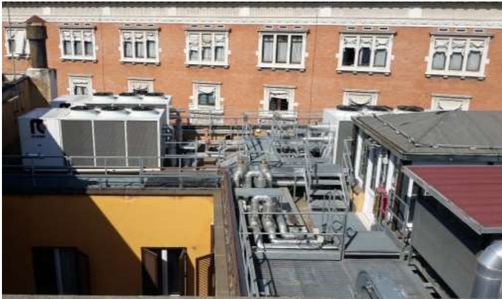
Figura 17: Vista dall'alto degli impianti termici
