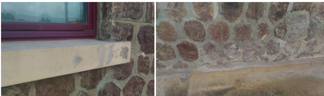
Figura 68. Segni di Infiltrazioni dagli infissi Museo PAS
