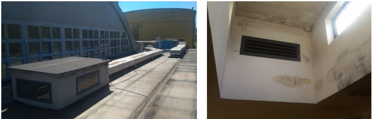
figura 45. Distribuzione aeraulico: canali esterni e presa del lucernaio
