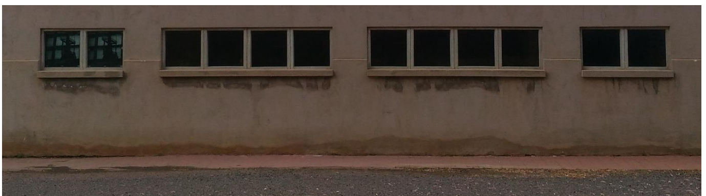
Figura 67. Segni di Infiltrazioni dagli infissi
