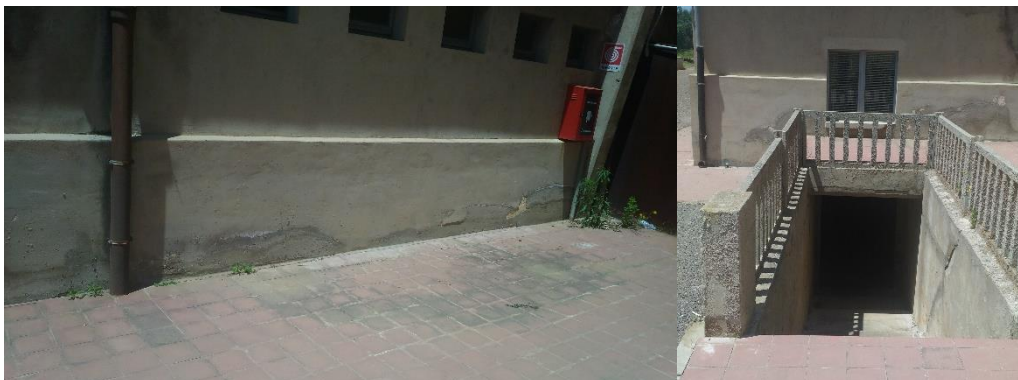
Figura 66. Degrado delle pavimentazioni e segni di degrado per umidità ascendente Museo Carbone
