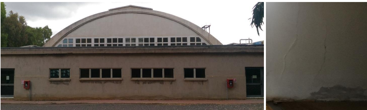
Figura 51. Segno esterno di umidità ascendente, segno nella muratura interna ne museo del carbone
