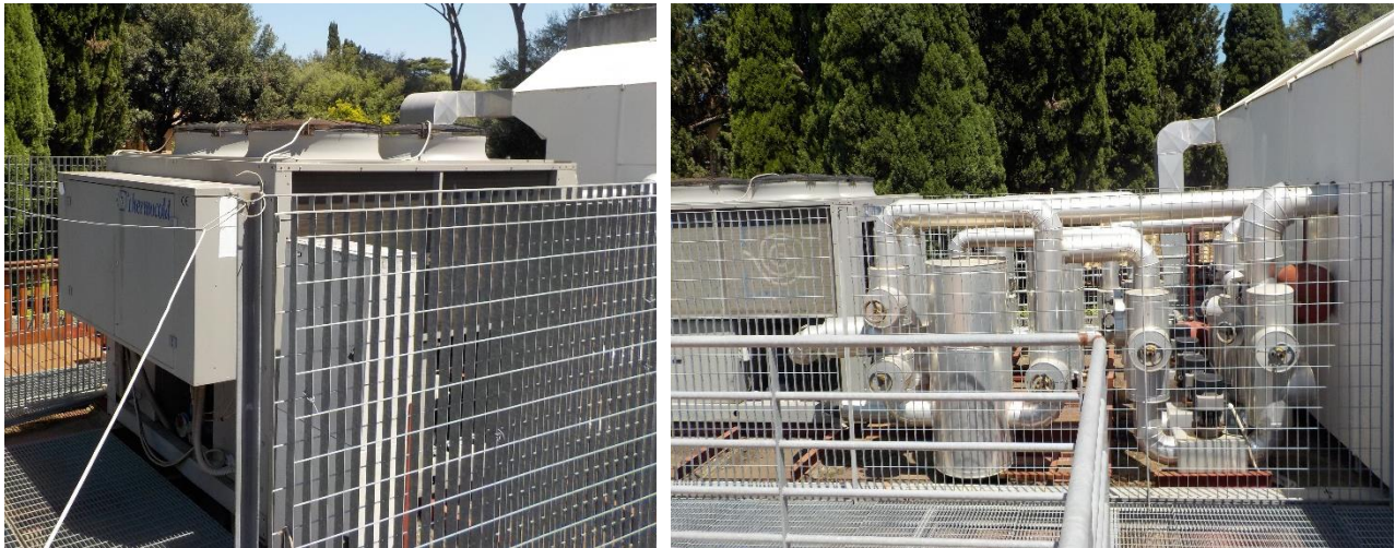
Figura 3.12 – Gruppo polivalente, pompe e serbatoi di accumulo.
