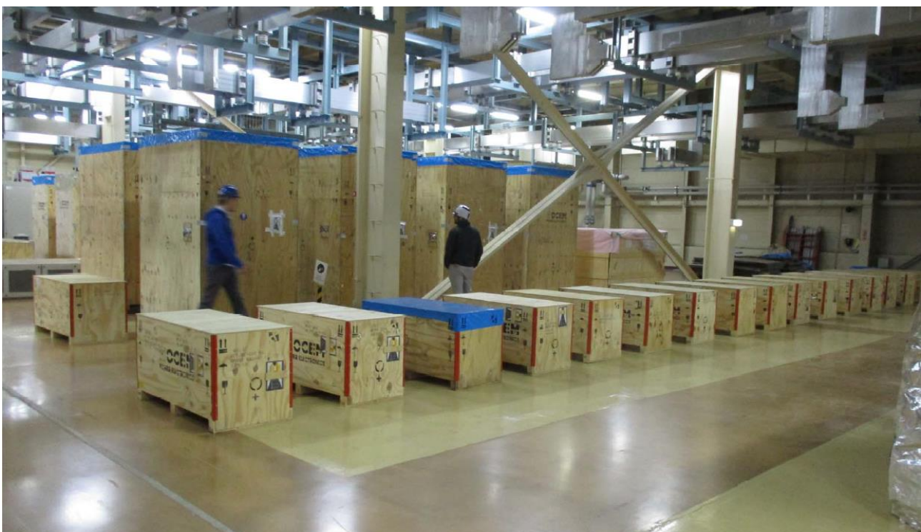
Figura 17. I componenti delle SNU finalmente pronti per l'installazione nella Rectifier Romm di JT-60SA a Naka.
