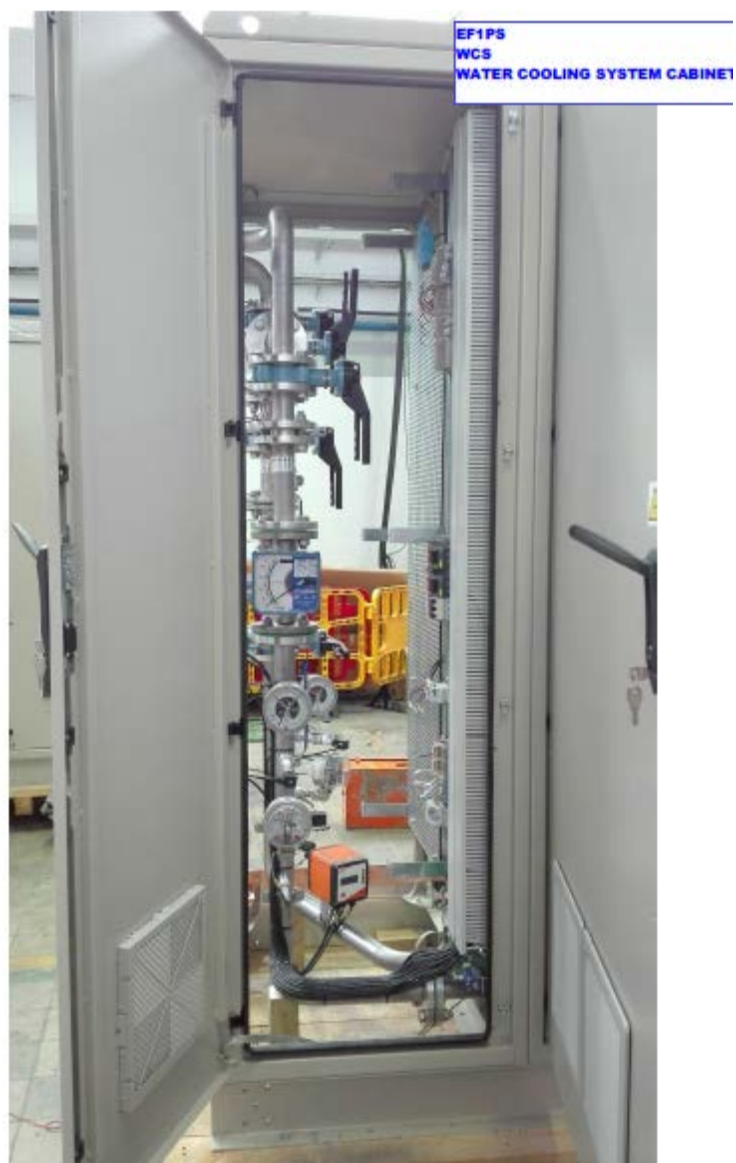
Figura 12 – dettaglio del Sistema di raffreddamento.
