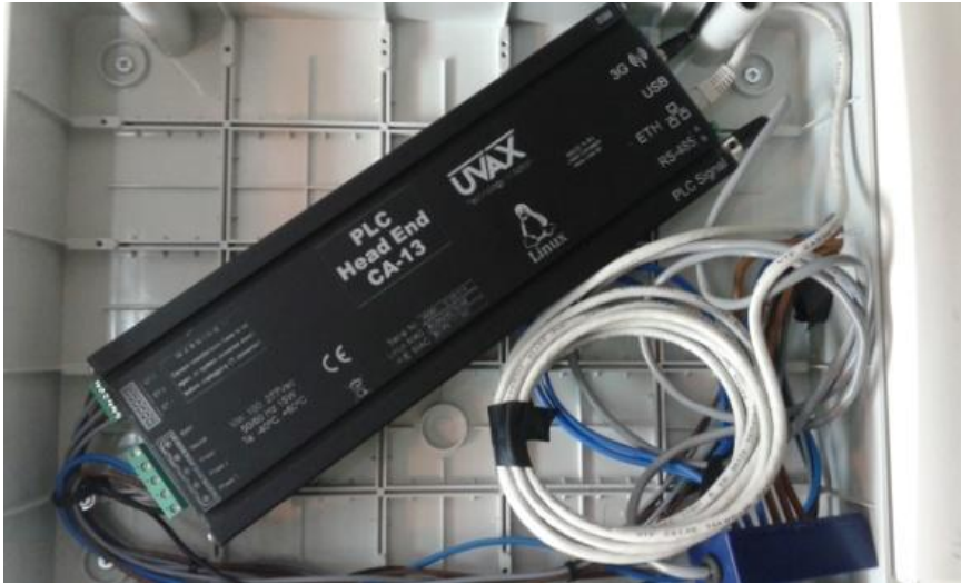
Figura 17 PLC installato in cabina per collegamento cabina-lampioni
