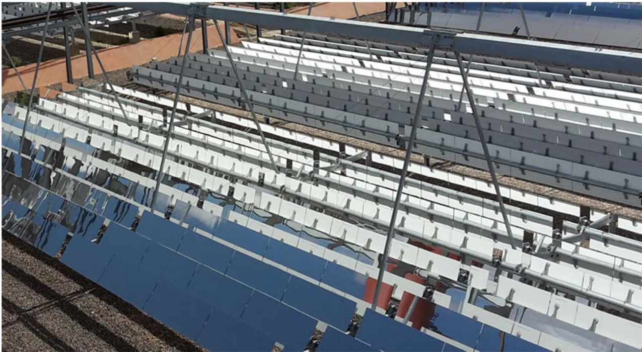
Figura 11. Concentratore lineare con riflettori di Fresnel installati nella centrale IRESEN 1 MWe CSP-ORC a Benguerir (Marocco).
