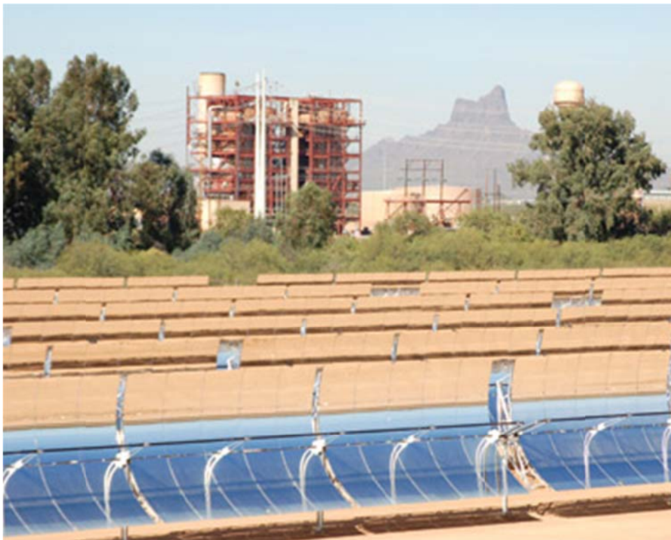
Figura 9. Concentratori parabolici lineari della centrale di Sanguaro (Arizona ,USA) [26].
