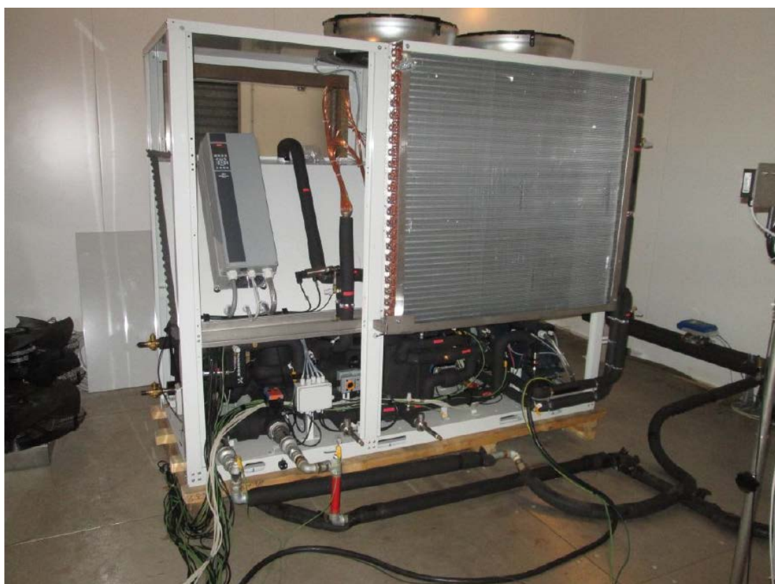
Figura 1. Prototipo di pompa di calore con sistema multi eiettore installato in camera climatica
